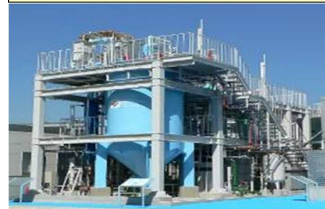
リン回収施設
