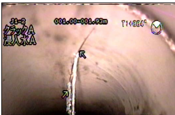
写真-1 クラックと浸入水
