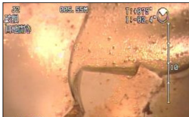
写真-2 破損した塩化ビニル管
