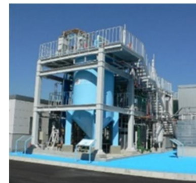
リン回収施設
