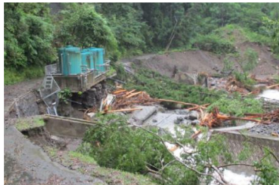
土砂崩れ等で破損した取水施設 (令和2年 熊本県八代市)
