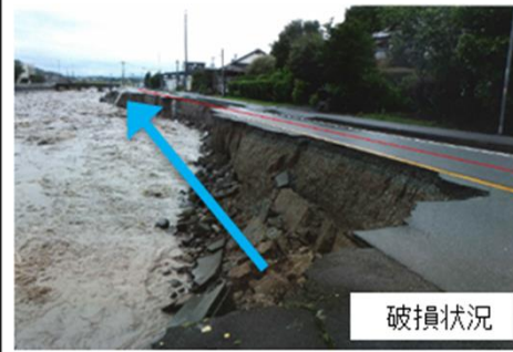
熊本県益城町 下水道管
