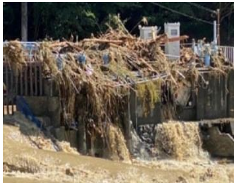
興津川承元寺取水口の被災状況 (令和4年 静岡県静岡市)
