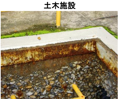
硫化水素により骨材露出
