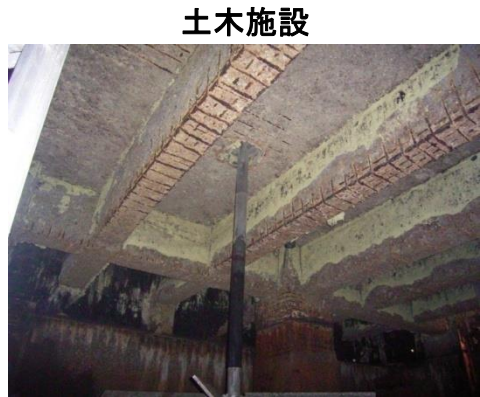
腐食が進行し鉄筋露出
