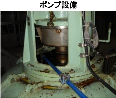
ポンプ本体(内部軸受)の劣化
