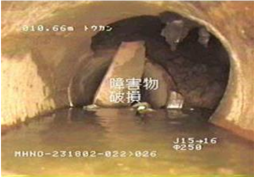
破損した管路
