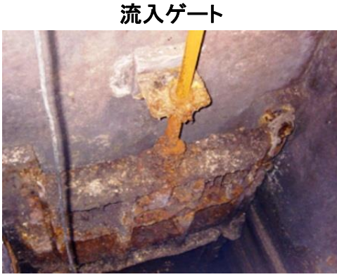
腐食が進行し開閉に支障
