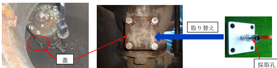
写真 5-2 空気弁に設置された蓋と採取孔設置の一例
