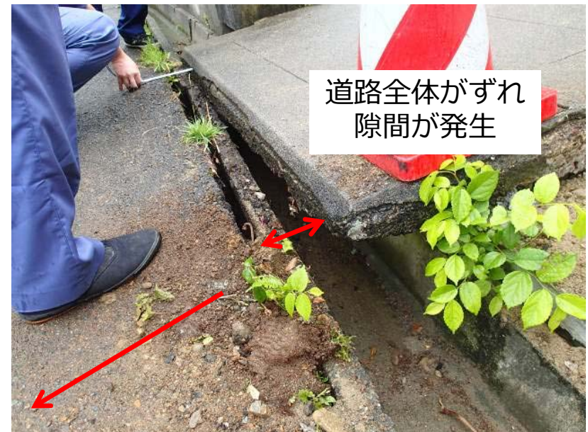
写真-15 民家と道路のずれ
