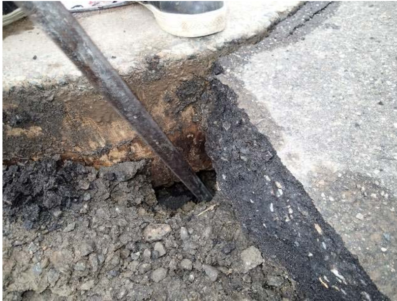
写真－5 マンホール側面の溝
