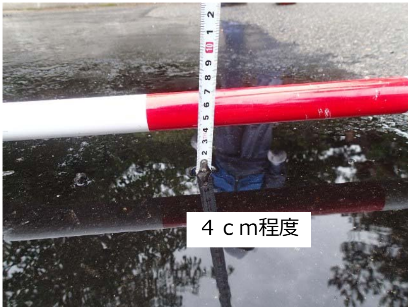
写真 - 11 再沈下の深さ確認
