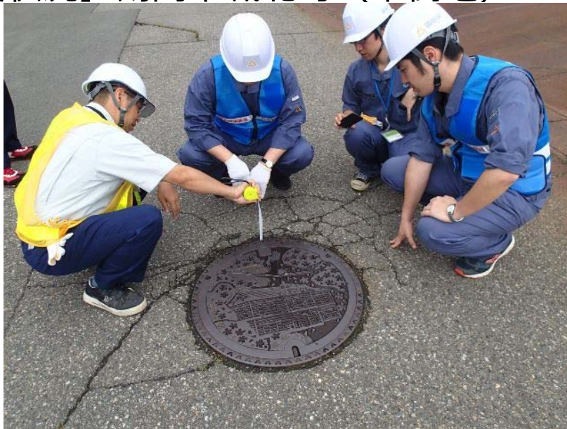
写真-1 マンホール周りの陥没（小規模）
