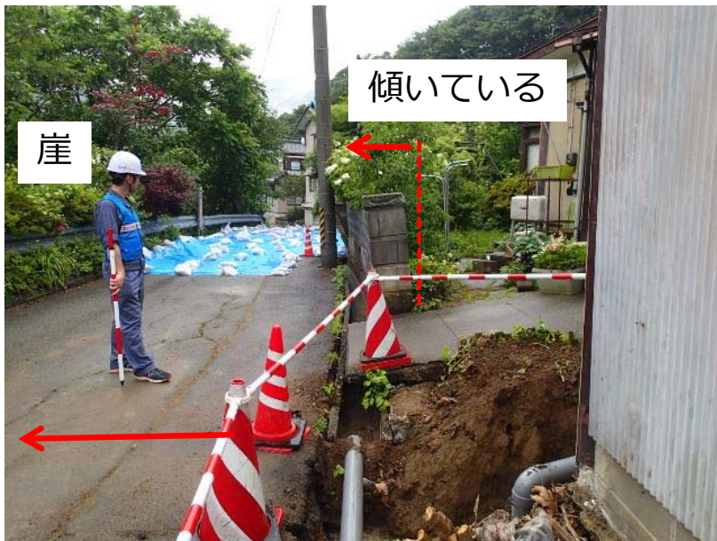
写真-14 民家の塀の傾き
