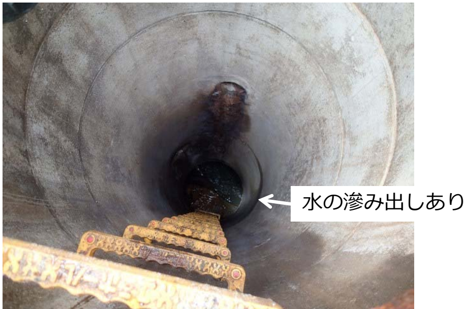
写真-3 陥没補修済みマンホールの内部
