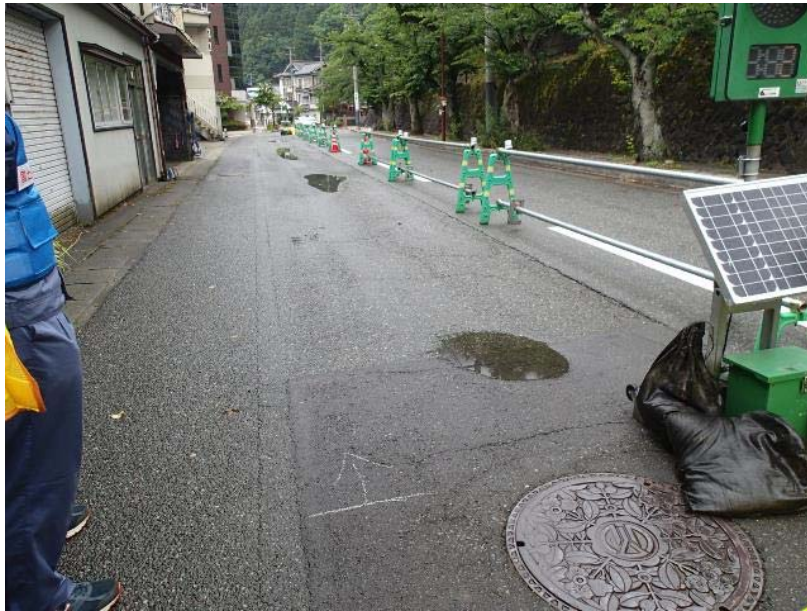
写真-16 縦断的な道路陥没
