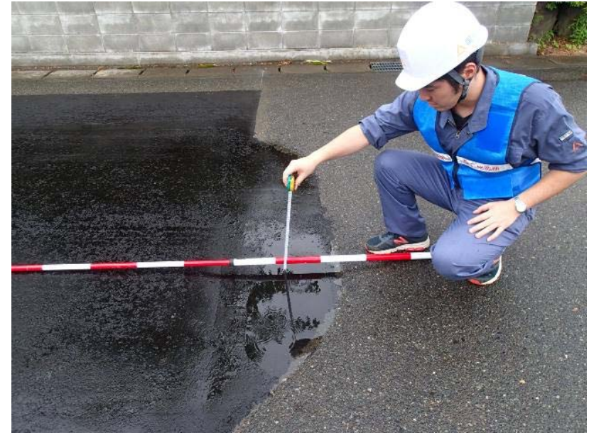
写真 - 10 再沈下の状況
