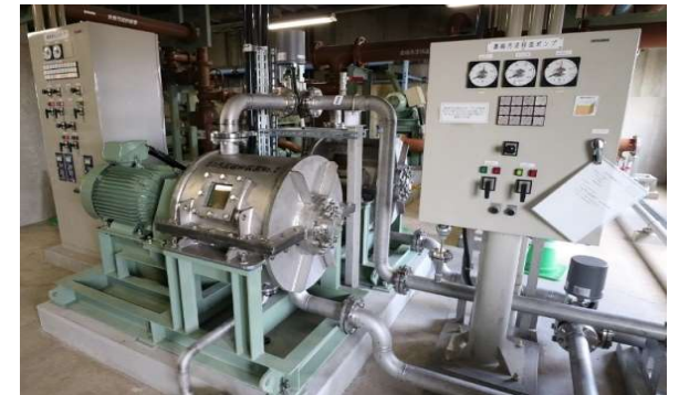
汚泥可溶化設備
