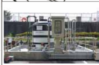
④ 凝集剤注入設備
