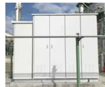
▲水素製造装置
