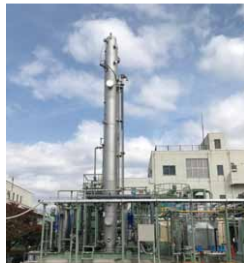
▲バイオガス精製装置
