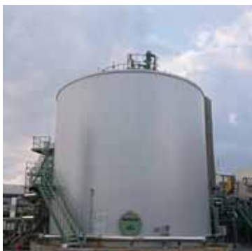
▲高濃度消化槽
