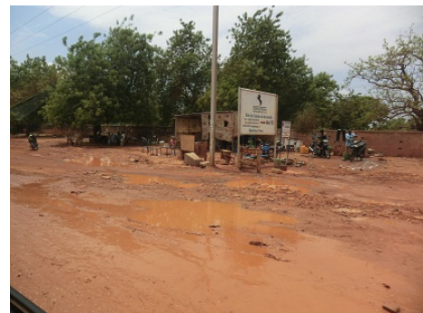
写真-7 降雨後の道路の様子
