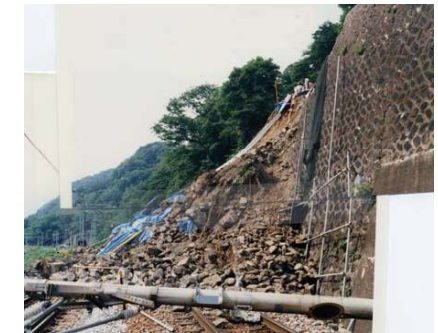
上越線石積土留壁倒壊(1987年)
