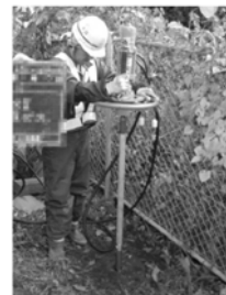
サウンディング孔を利用してパイプハンマーで観測井を設置
