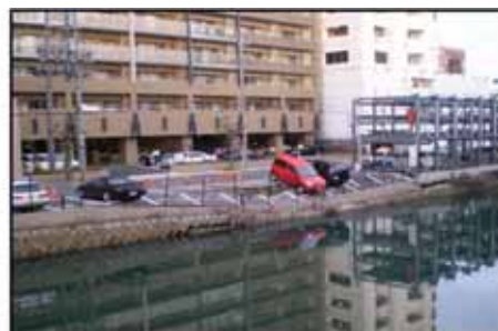
護岸の損壊状況
