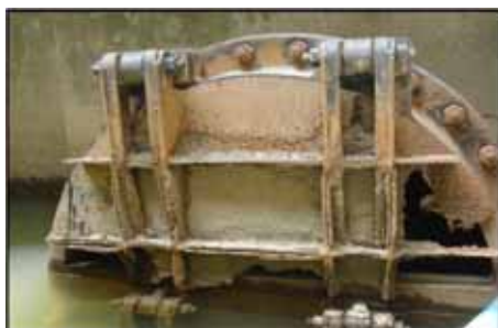
ポンプ設備(逆流防止弁)の損壊状況
