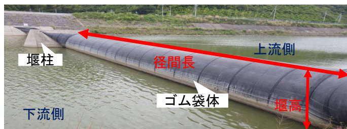
ゴム堰の全景事例
