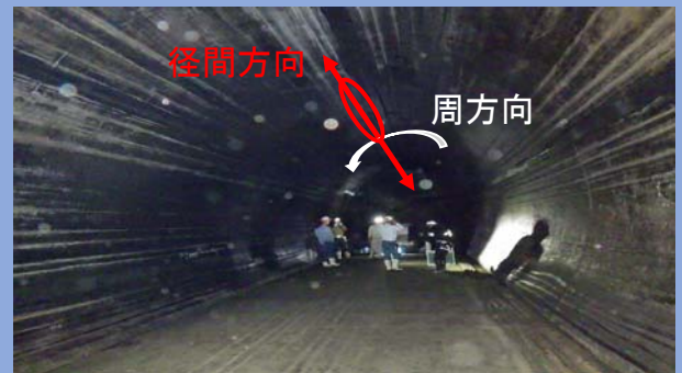
堰内部剥離箇所
