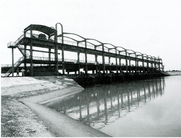
写真-6 上流左岸側から見た河口部付近のフラップゲート式潮留め堰。本堤との取り付け部はコンクリートでカバーされている。実際の川幅は堰の幅の何十倍も広い
