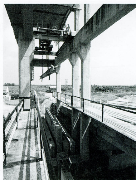
写真-9 ゲートのメンテナンス用のクレーン。下の方に仕切り板が見える。クレーンで仕切り板をゲート位置にセットし、ゲート本体をメンテナンスする
