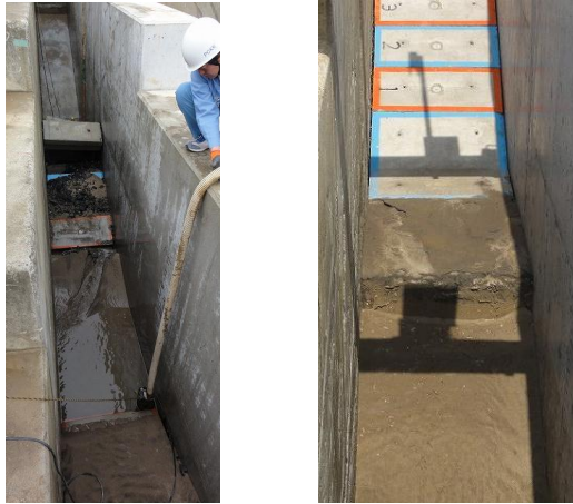
基礎工、裏法被覆工、フィルター層、堤体土が流失 地盤改良部分の表面が削れたが、流失していない
