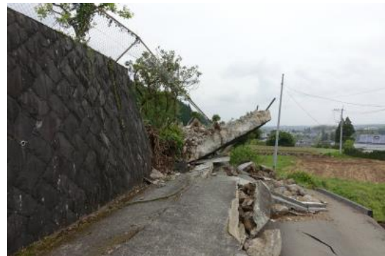
写真 3.3-11 崩壊した擁壁
