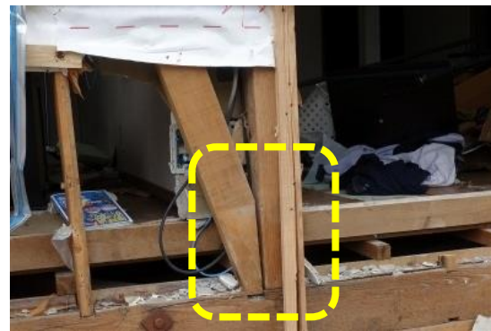
写真 3.3-15 写真 3.3-14 のアパートの柱脚部 （柱脚、筋かい端部は釘打ちのみ）
