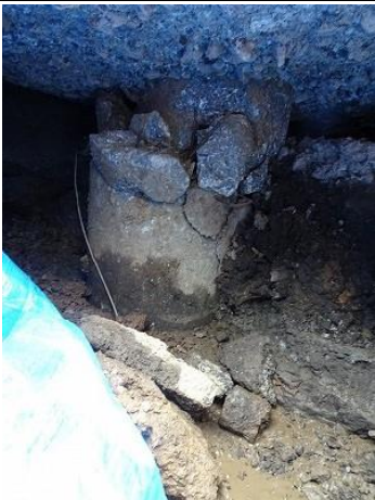
写真 3.5-7 コンクリート杭端部の損傷
