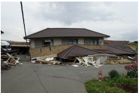
写真 3.3-16 倒壊した木造住宅
