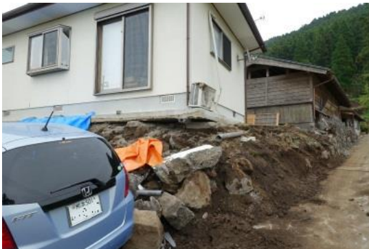
写真 3.3-10 崩壊した擁壁
