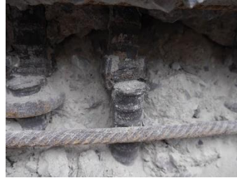
写真 3.5-2 溶接部が破断した柱主筋
