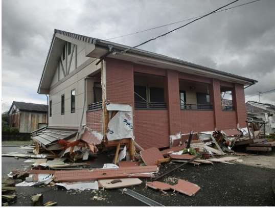
写真 3.3-6 倒壊した木造住宅
