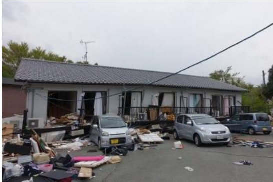
写真 3.3-12 倒壊した木造アパート
