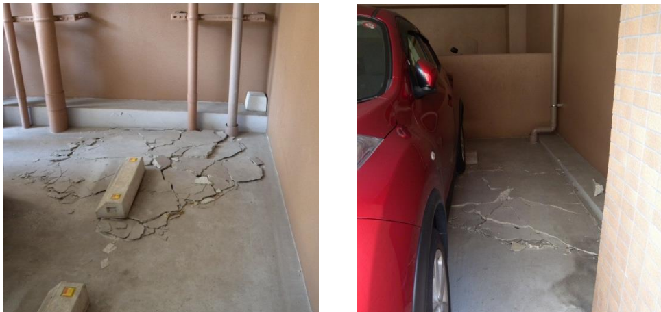
写真 3.7-2 免震層上面の床スラブの損傷 (建築物I)
