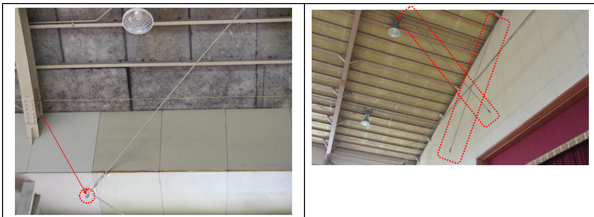
写真 3. 4-7 屋根面水平ブレースのボルト破断
