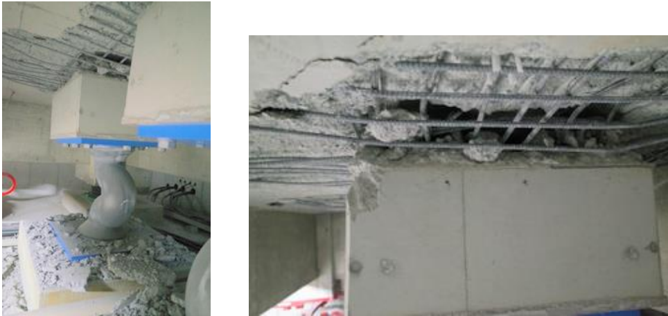
写真 3.7-1 鉛ダンパー取付け基部の被害 (建築物C)
