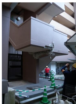
写真 3.7-4 外付け階段の被害 (建築物G)
