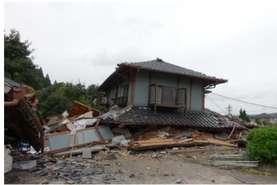
写真 3.3-9 倒壊した木造住宅
