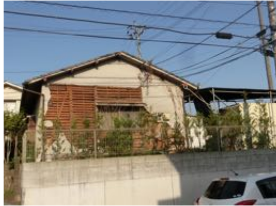
写真 5.5.3 モルタル外壁が剥落した平屋の家屋
