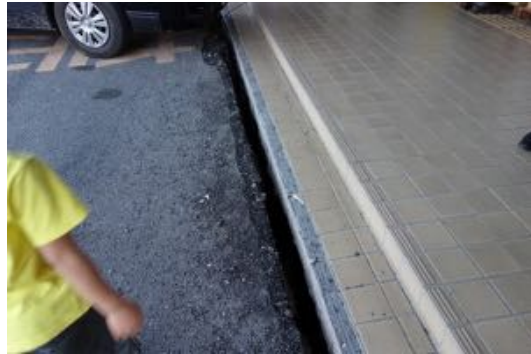
写真 5.4.2 玄関前の基礎版と周辺地盤の隙間
