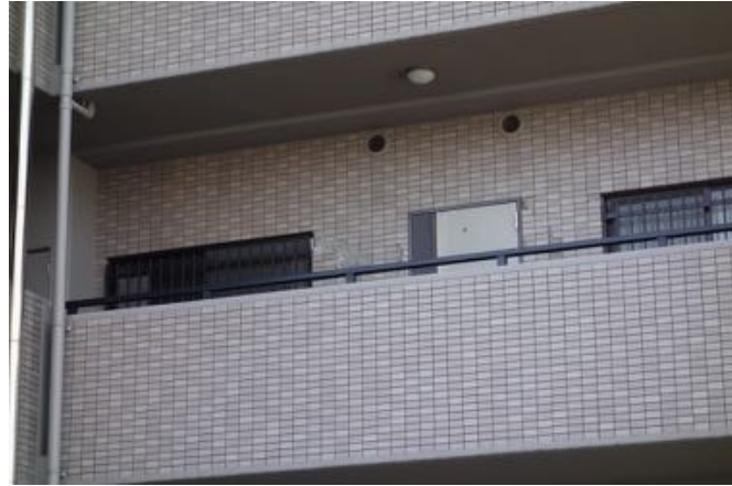
写真 5.2.2 渡り廊下部分と非構造壁の被害
