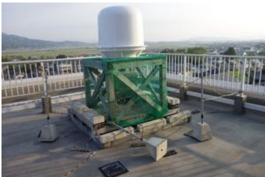
写真 5.4.3 屋上の設備の損傷（脚部）
