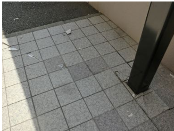
写真 5.2.3 入り口付近のタイルの割れ
