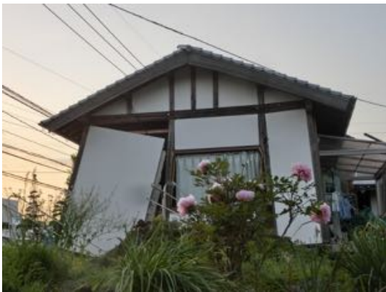
写真 5.5.4 壁が外れた家屋
