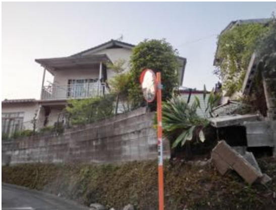
写真 5.5.12 増し積み擁壁の被害
