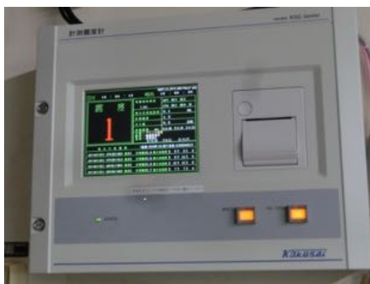
写真 5.6.2 益城町の計測震度計の記録盤
