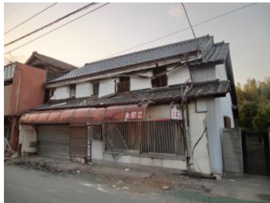
写真 5.5.7 土壁を有する伝統的な町屋の被害
