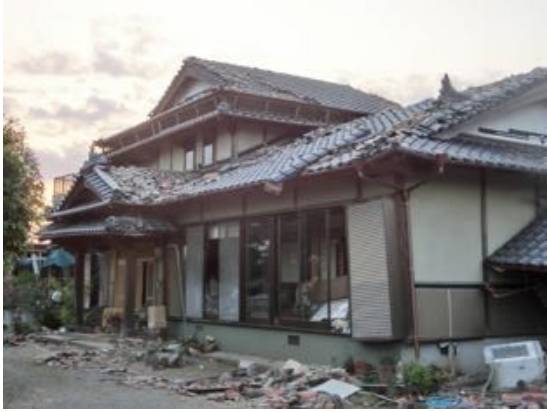
写真 5.5.8 比較的新しい伝統的構法の被害
