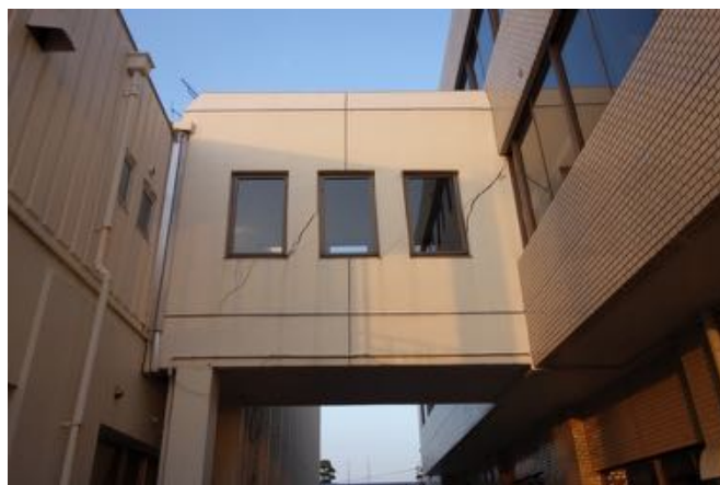
写真 5.4.5 渡り廊下の損傷
