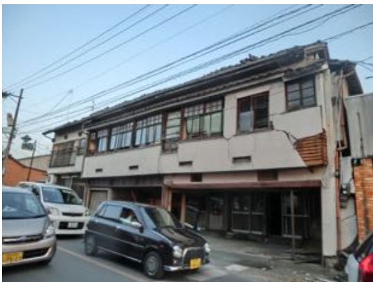
写真 5.5.6 軸組構法の店舗併用住宅の被害
