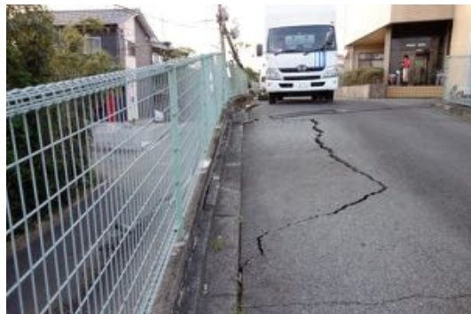
写真 5.4.4 敷地内の舗装のひび割れ
