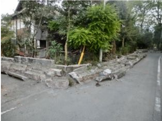
写真 5.5.14 組積造の塀の被害
