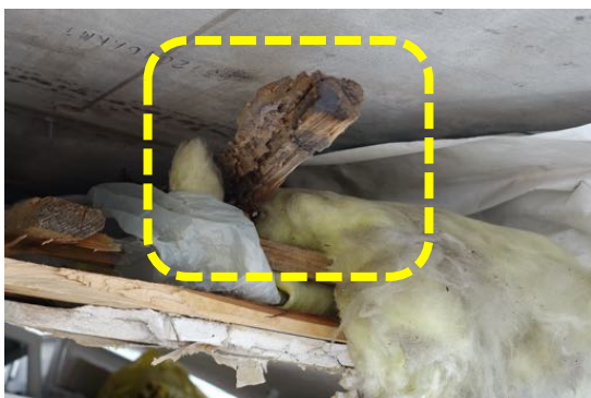
写真 4.21 筋かい端部 (蟻害による著しい断面欠損)
