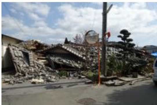
写真 2.1 倒壊した木造住宅
