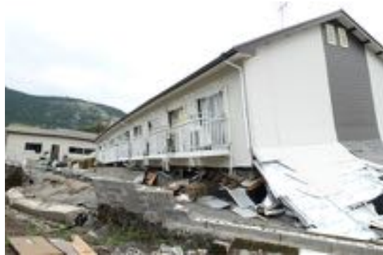
写真 4.30 倒壊したアパート③
