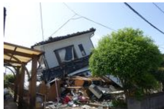
写真 2.12 倒壊した木造住宅
