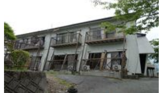
写真 4.8 傾斜した木造アパート
