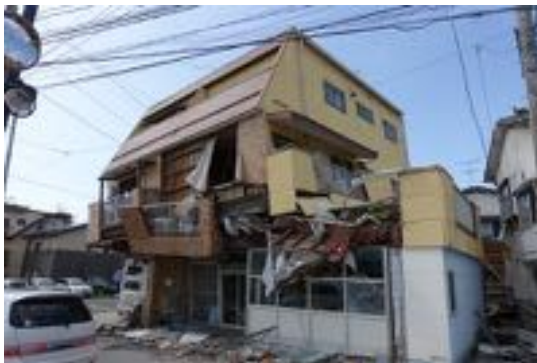
写真 2.7 2階が崩壊した鉄骨造の3階建て店舗併用住宅
