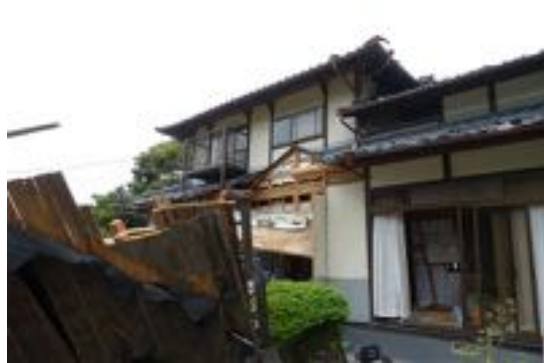
写真 3.6 玄関部分が部分破壊した木造住宅
