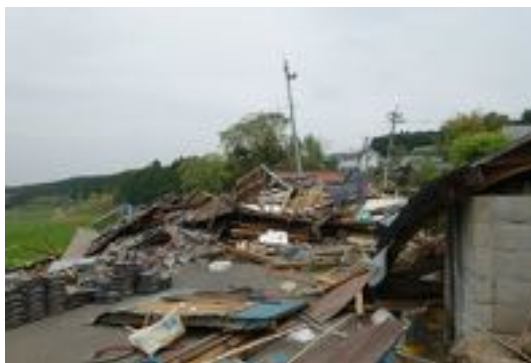
写真 3.16 倒壊した木造住宅
