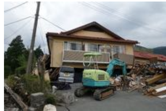
写真 4.12 倒壊した木造住宅
