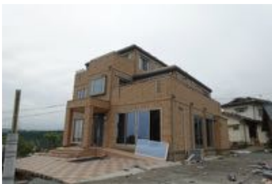
写真 3.7 敷地の被害を受けた住宅
