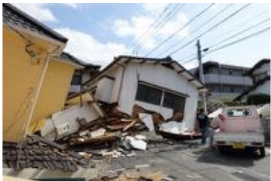
写真 2.16 倒壊した木造住宅
