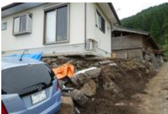
写真 3.9 崩壊した擁壁
