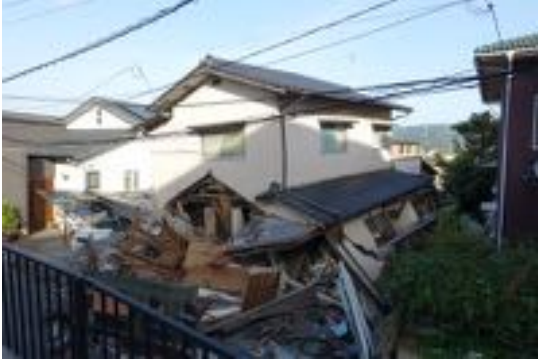
写真 2.29 倒壊した木造住宅
