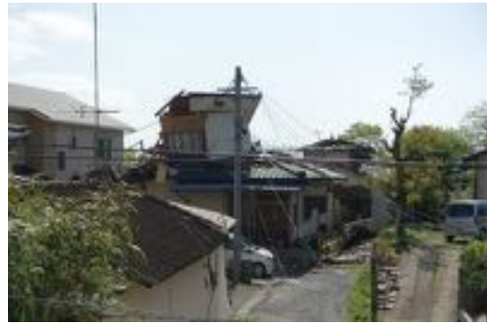
写真 2.18 2階が破壊した木造住宅
