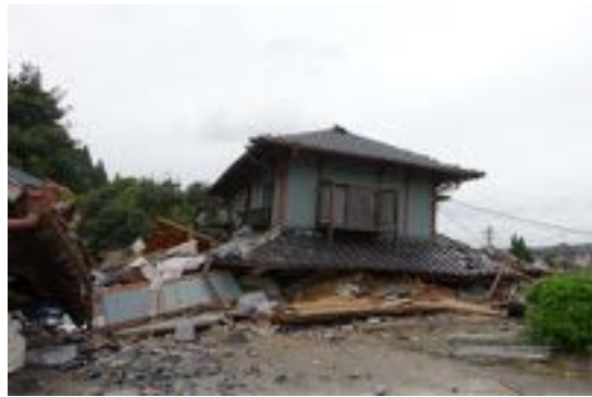
写真 3.4 倒壊した木造住宅
