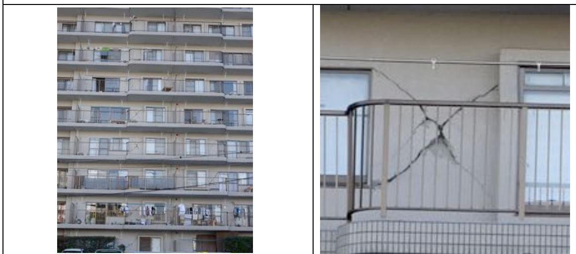
写真 3.1.9-2 桁行き方向バルコニー側の方立て壁のせん断破壊
