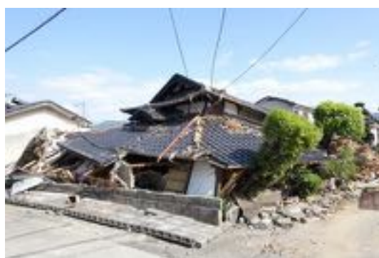
写真 2.2 倒壊した木造住宅
