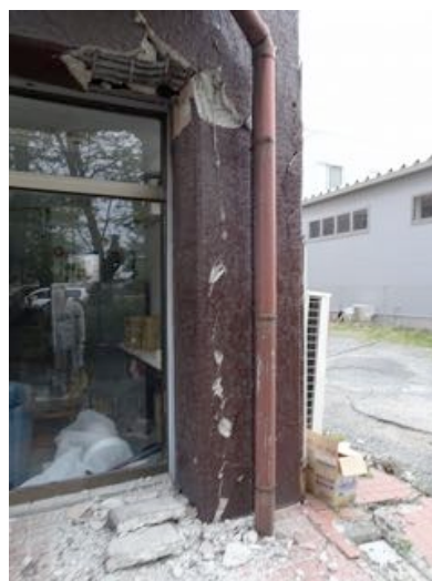
写真 3.1.19-4 1 階柱(北東側)の主筋付着割裂ひび割れと 2 階梁端部の破壊
