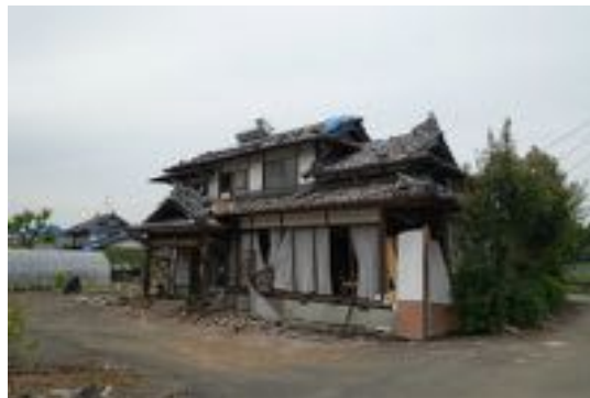
写真 3.24 大破した木造住宅
