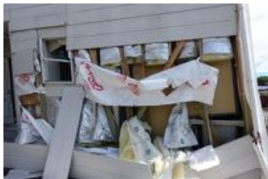
写真 2.24 写真 2.23 の建物の破壊部分
