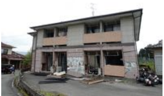
写真 4.7 傾斜した木造アパート
