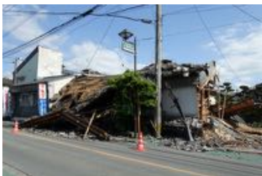
写真 2.3 倒壊した木造住宅
