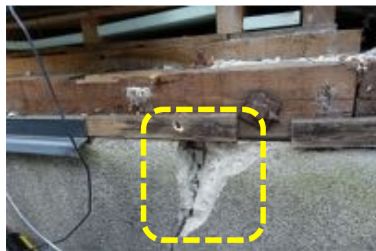
写真 4.22 基礎の亀裂部 (無筋コンクリート基礎+アンカーボルト)
