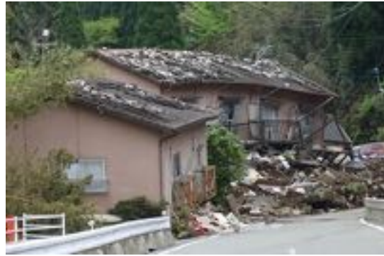
写真 4.10 倒壊した木造アパート
