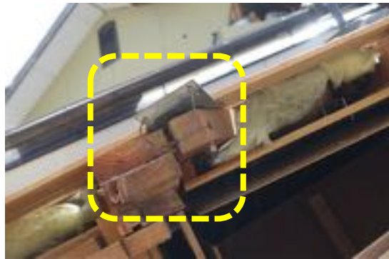
写真 2.22 写真 2.21 の住宅の柱脚部 (柱脚柱頭金物確認できず、筋かい金物あり)
