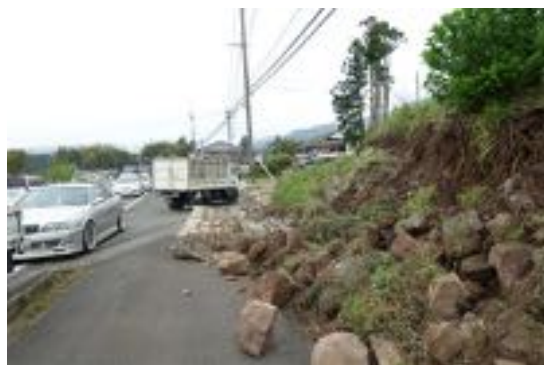
写真 3.8 崩壊した擁壁
