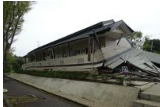
写真 4.24 倒壊したアパート②
