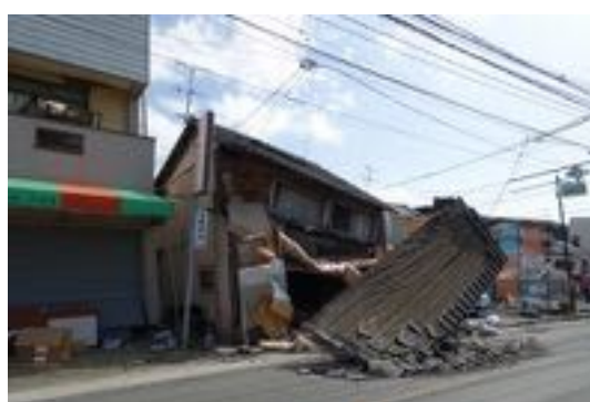
写真 2.4 倒壊した木造住宅
