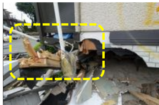
写真 4.28 通し柱の曲げ破壊
