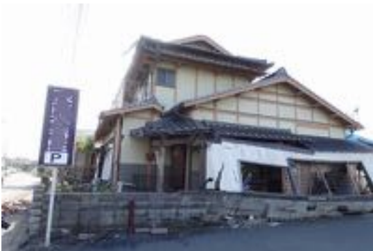
写真 2.31 部分破壊した木造住宅
