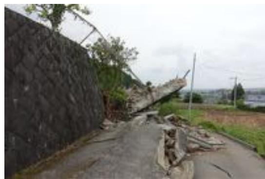
写真 3.10 崩壊した擁壁
