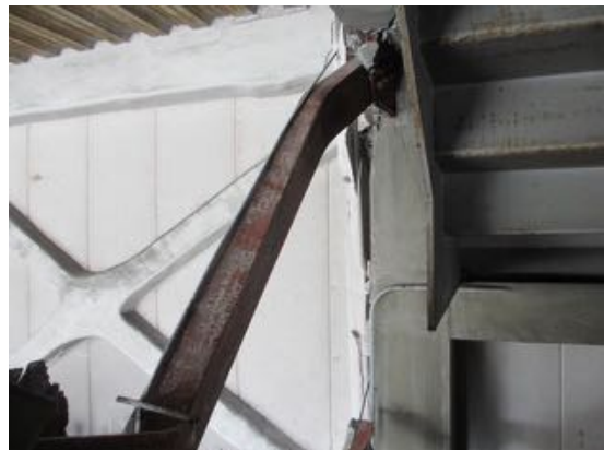
写真 4. 2. 1. 6 溝形鋼ブレース端部の座屈
