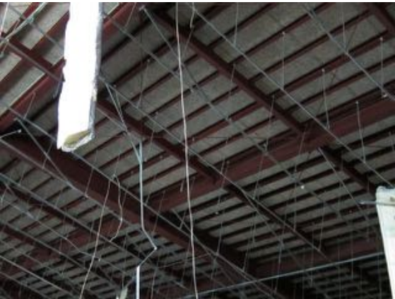
写真4.2.2.9 天井が脱落した天井懐の状況
