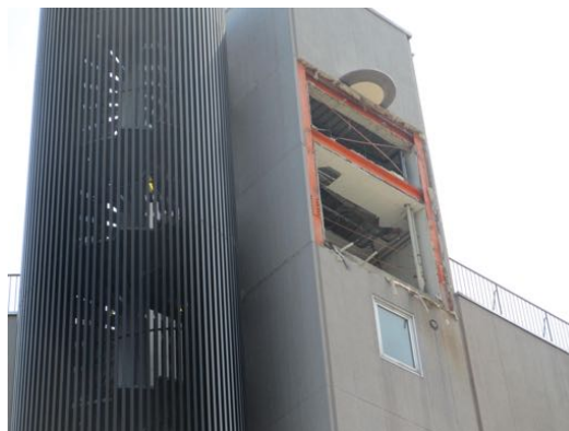
写真 4.2.1.9 塔屋の外装材の脱落
