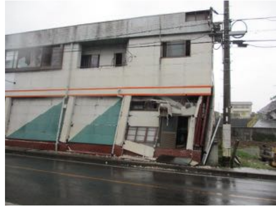
写真4.2.1.25 1層の大きな傾き（南面）
