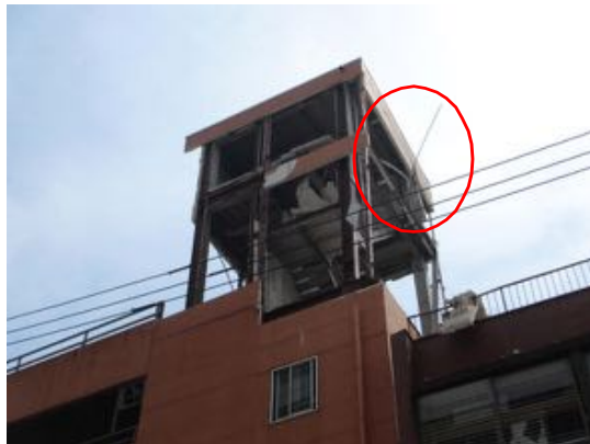
写真 4. 2. 1. 14 塔屋のブレースの破断
