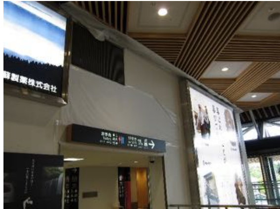
写真 4. 2. 2. 6 天井と壁の取合い部分での損傷
