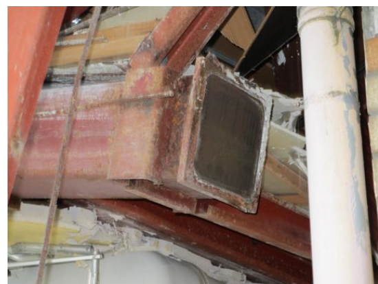
写真4.2.1.23 柱梁接合部のパネル溶接部の破断
