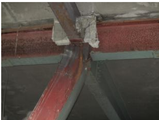
写真4.2.1.31 1階柱頭部の破壊
