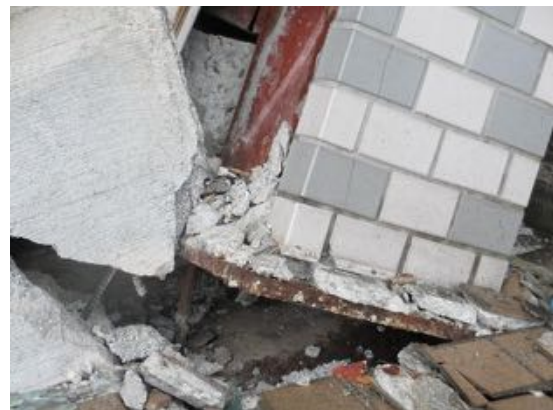
写真 4. 2. 1. 17 柱脚部の損傷状況
