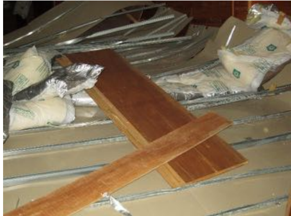
写真4.2.2.8 脱落した天井材
