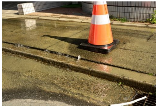
写真 4. 2. 3. 2 被害建築物付近での漏水
