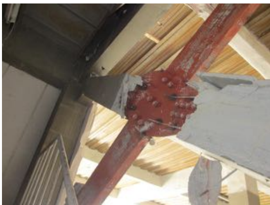
写真 4. 2. 1. 7 ブレース交差部のガセットプレート接続部の座屈
