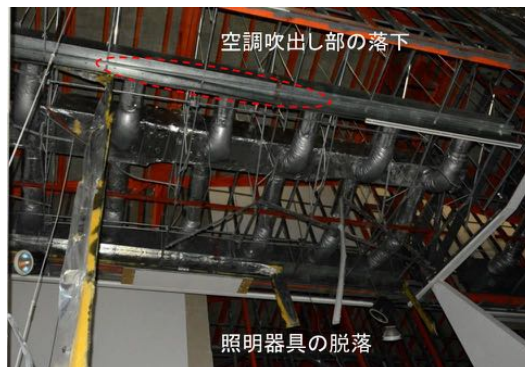
写真 4. 2. 3. 5 照明器具・空調吹き出し部の脱落
