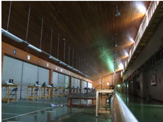
写真4.2.2.10 天井が脱落しなかった室
