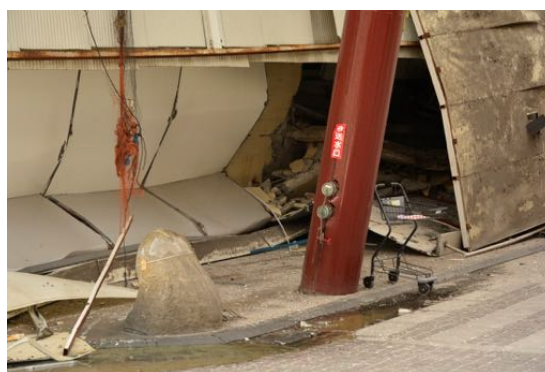
写真 4. 2. 3. 3 連結送水管送水口の付近の破損
