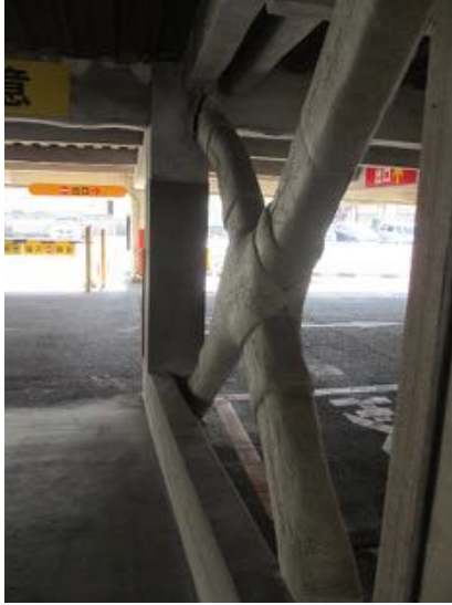
写真 4. 2. 1. 3 ブレースの座屈
