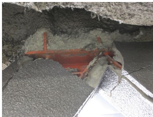
写真 4.2.1.11 ブレース交差部の耐火被覆の剥離
