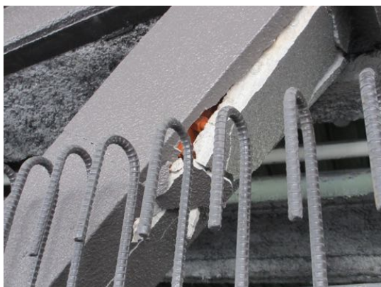
写真 4.2.1.10 ブレース端部の耐火被覆の亀裂
