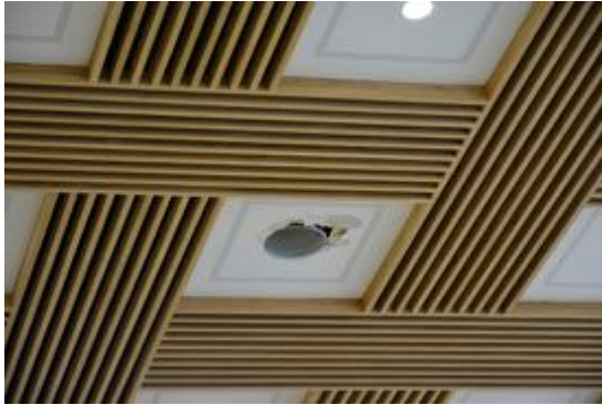
写真 4.2.3.6 空調吹出し部の脱落
