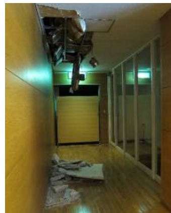
写真4.2.2.4 破損したコンクリート片の落下
