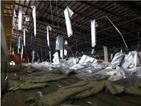
写真4.2.2.7 天井脱落の状況
