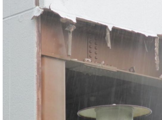
写真4.2.1.33 外壁落下で露出した柱梁接合部
