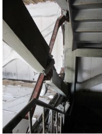
写真 4. 2. 1. 4 ブレースの耐火被覆の剥落
