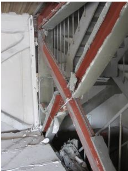
写真 4. 2. 1. 5 溝形鋼ブレースの座屈
