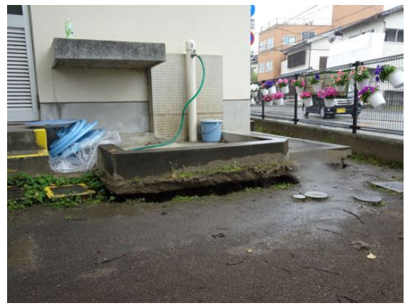
写真 5.12 小学校校舎の周辺地盤の沈下状況（熊本市南区近見）
