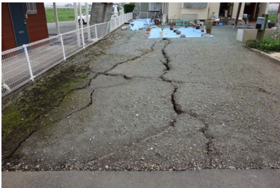
写真 4.20 写真 4.19 の建築物の周辺地盤、秋津川近くは地盤変状が大きい。
