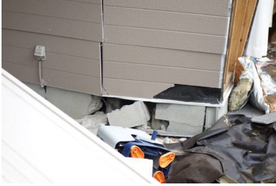
写真 4.36 写真 4.35 の建築物の基礎。破壊しているが打継があるようにも見える。
