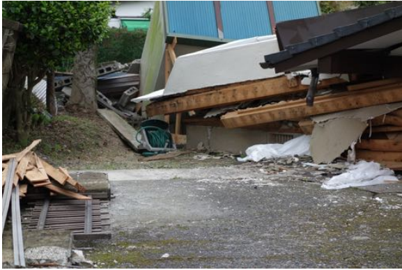
写真 4.3 写真 4.2 の基礎のひび割れを確認。地盤変状は確認できなかった。
