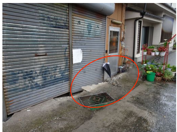
写真 5.8 写真 5.7 の建築物の 1 階部分の沈下状況
