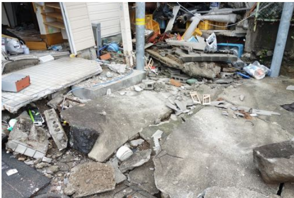
写真 4.34 写真 4.32 の建築物の周辺地盤。地盤変状は大きいと思われる。
