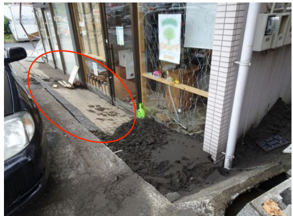
写真 5.6 写真 5.5 の建築物の 1 階部分の沈下状況
