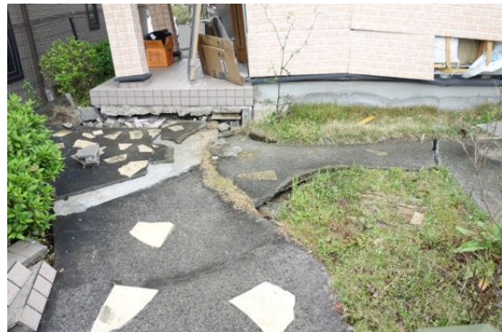
写真 4.39 写真 4.38 の建築物の周辺地盤。変状は認められるが、基礎の損傷は見えない。
