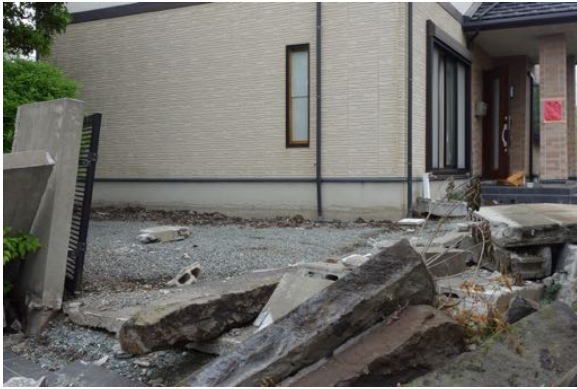
写真 4.12 写真 4.11 の建築物の基礎と周辺地盤。地盤変状が認められるが、基礎は無被害
