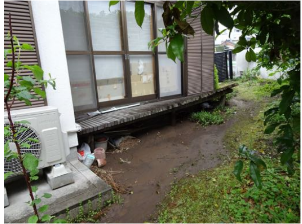
写真 5.4 写真 5.3 の建築物の縁側部分の沈下状況
