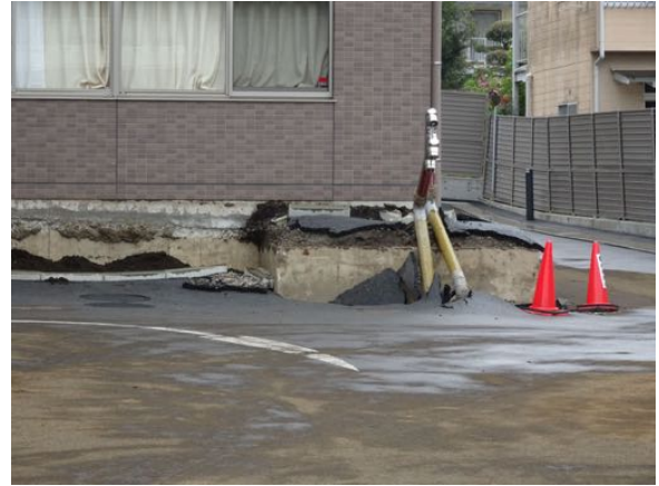
写真 5.10 写真 5.9 の建築物の周辺地盤の沈下状況（平成 28 年 4 月 23 日午後撮影）
