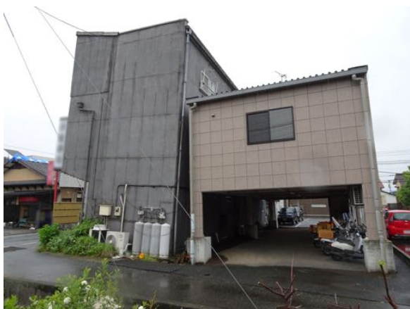
写真 5.16 地盤の液状化によると思われる隣接建築物同士が近づくような傾斜形態
