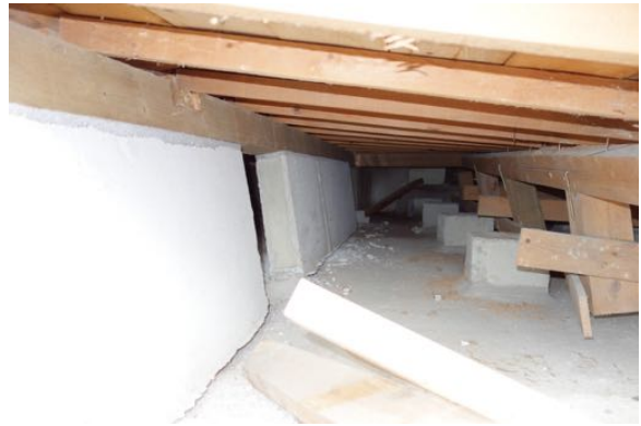
写真 4.33 写真 4.32 の建築物の基礎。床束は全て外れ、基礎は立ち上がり部で曲げ破壊が生じている。
