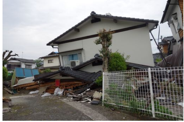
写真 4.2 1 階が倒壊している建築物
