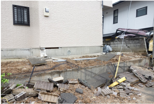
写真 4.42 写真 4.41 の建築物の基礎。ひび割れが認められるが、破壊はしていない。地盤変状は認められる。
