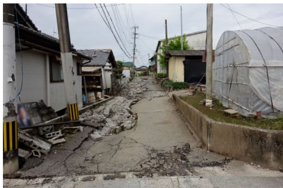
写真 4.10 A 通り・県道 28 号南側の道路の舗装の様子。北側に比べて損傷が大きく見える。
