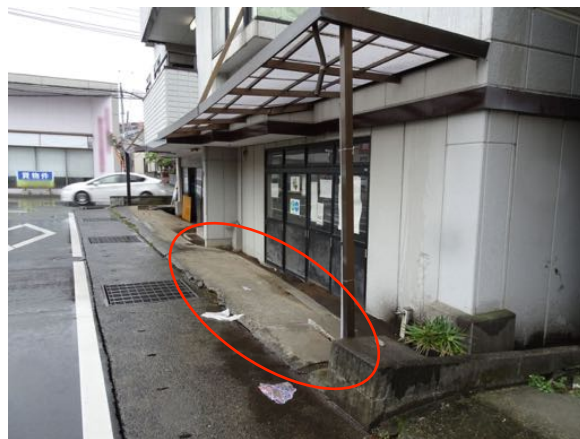
写真 5.15 写真 5.14 の建築物の 1 階部分の沈下状況
