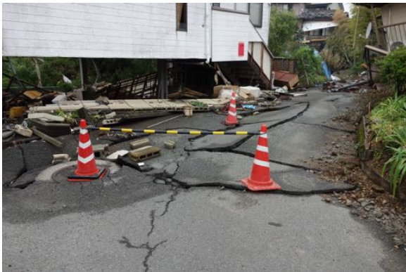
写真 4.21 B通り・県道28号北側の道路の舗装の様子（被害の大きい箇所）
