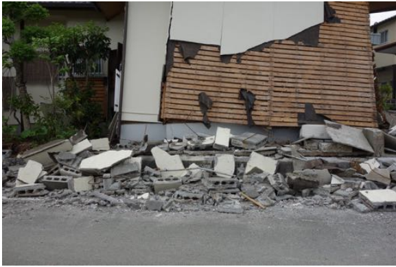
写真 4.18 写真 4.17 の建築物の基礎周りの様子。基礎にひび割れが見られ、地盤変状も認められる。
