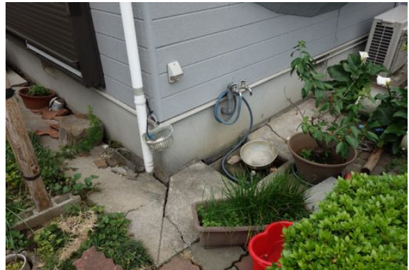
写真 4.15 写真 4.14 の基礎周りの様子。地盤変状が生じていると思われる損傷が見られる。
