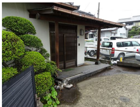
写真 5.2 写真 5.1 の建築物の 1 階玄関部分の沈下状況
