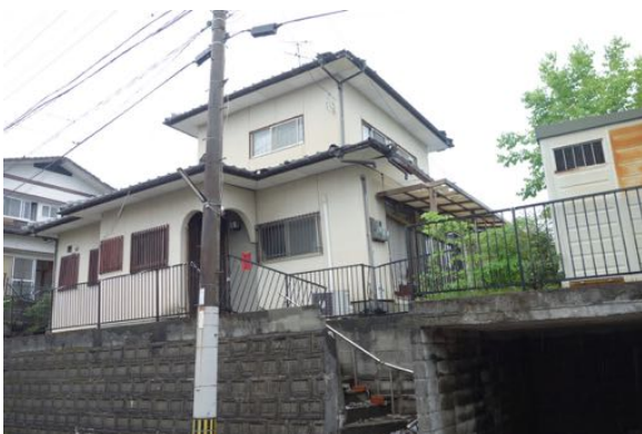
写真 4.23 軽微・無被害に見える建築物。擁壁に損傷あり。
