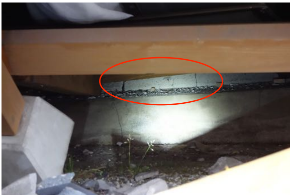
写真 4.27 写真 4.26 の建築物で確認できた基礎の様子。一部にひび割れを確認できる
