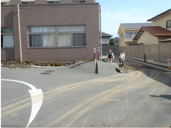
写真 5.11 写真 5.9 の建築物の周辺地盤の沈下状況（平成 28 年 4 月 15 日午前撮影）
