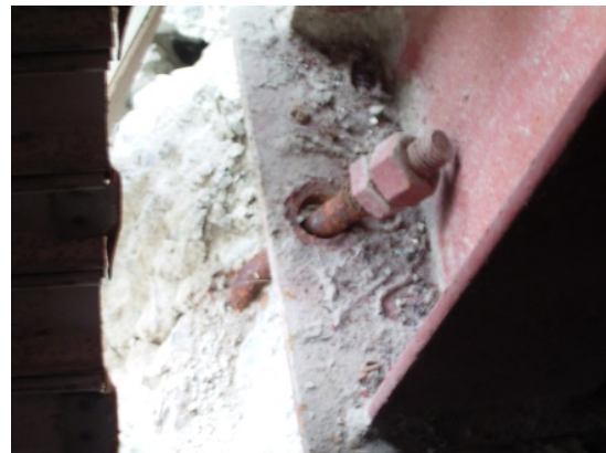
写真 5.8.2 柱脚部の損傷状況
