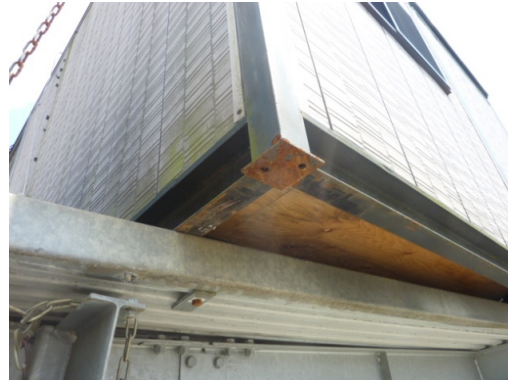
写真 5.16.4 柱脚部ボルト破断
