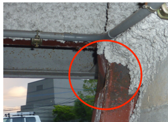
写真 5.12.4 柱の局部座屈
