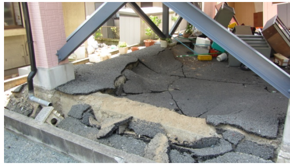
写真 5.15.4 宅地の地盤変状
