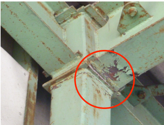
写真 5.14.3 梁端溶接部の破断
