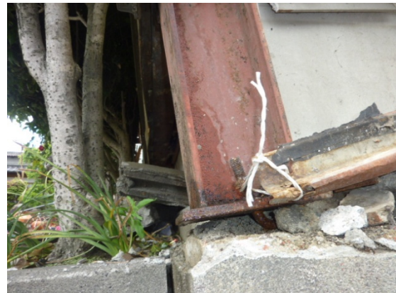
写真 5.3.2 柱脚部の損傷状況
