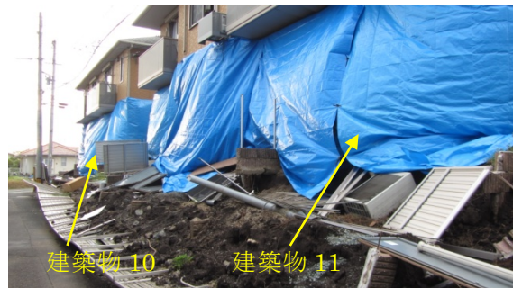
写真 5.10/11.3 宅地擁壁部分の崩壊
