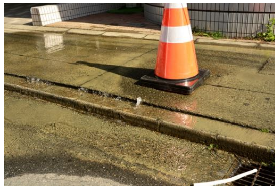
写真 4. 2. 3. 2 被害建築物付近での漏水
