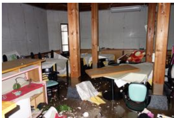
写真 5.1.4 RC 造食堂棟の内部の被害状況
