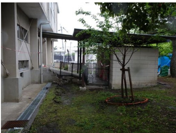
写真 5.13 写真 5.12 の小学校の体育館の周辺地盤の沈下状況
