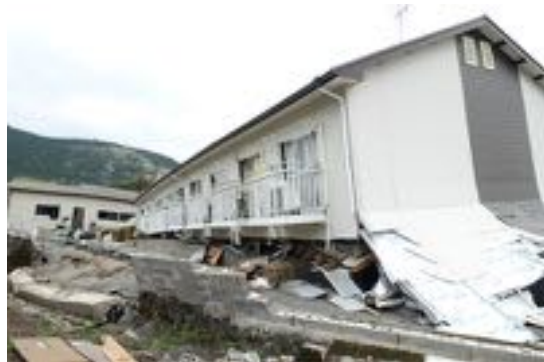
写真 4.30 倒壊したアパート③
