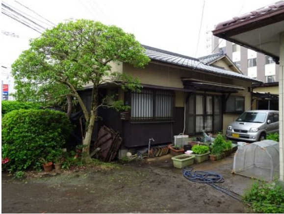
写真 5.3 地盤の液状化により基礎の損傷を伴って沈下したと思われる平屋建て木造住宅
