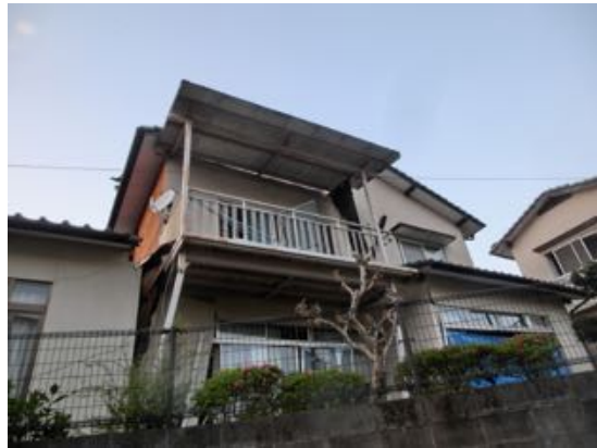
写真 5.5.15 写真 5.5.12 の擁壁に支えられ、宅地変状により被害が甚大な家屋
