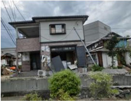
写真 5.7.7 最近の建築と思われる住宅で被害が大きい例
