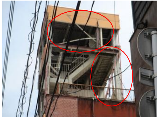
写真 4. 2. 1. 13 塔屋のブレースの破断
