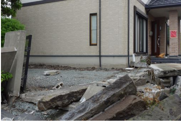
写真 4.12 写真 4.11 の建築物の基礎と周辺地盤。地盤変状が認められるが、基礎は無被害
