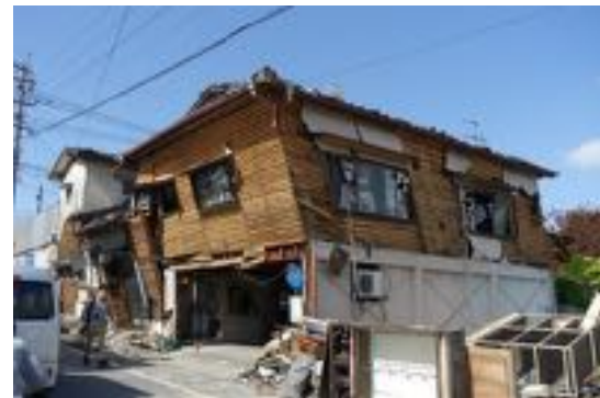
写真 2.8 2階が大きく傾斜した1階鉄骨造+2階木造の店舗併用住宅
