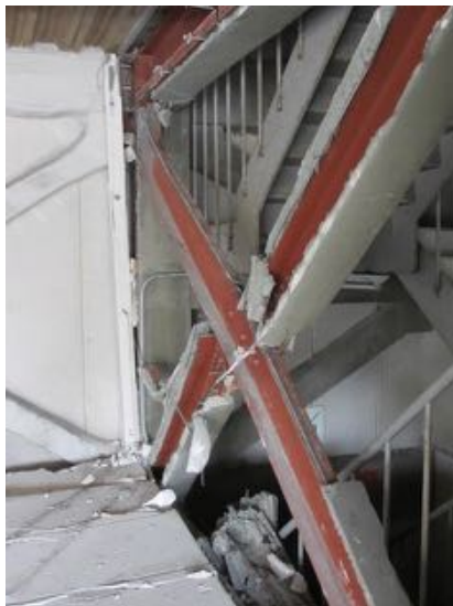
写真 4. 2. 1. 5 溝形鋼ブレースの座屈
