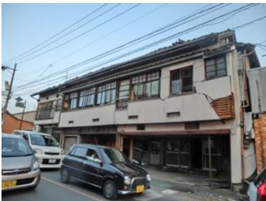
写真 5.5.6 軸組構法の店舗併用住宅の被害
