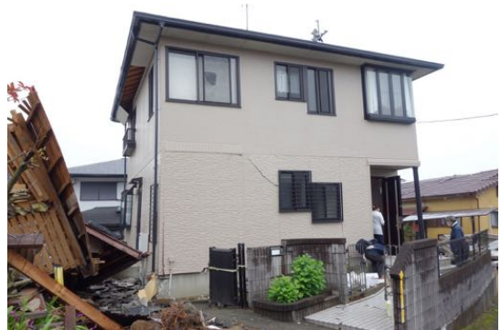
写真 4.41 大破と思われるが倒壊には至っていない建築物
