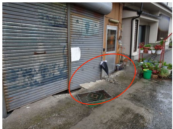
写真 5.8 写真 5.7 の建築物の 1 階部分の沈下状況
