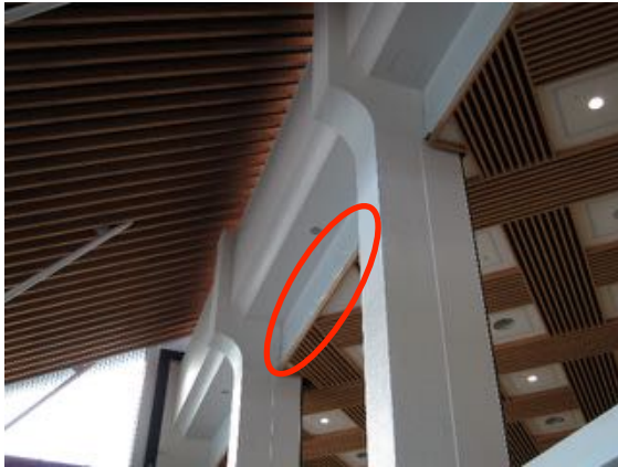
写真 4. 2. 2. 5 立ち上がり壁の脱落箇所
