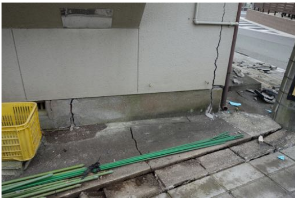
写真 4.5 写真 4.4 の基礎のひび割れ及び地盤変状を確認
