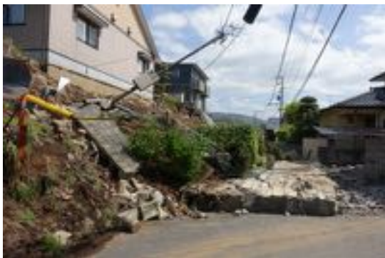
写真 2.27 崩壊した擁壁
