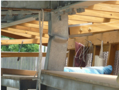
写真 5.16.3 柱の局部座屈
