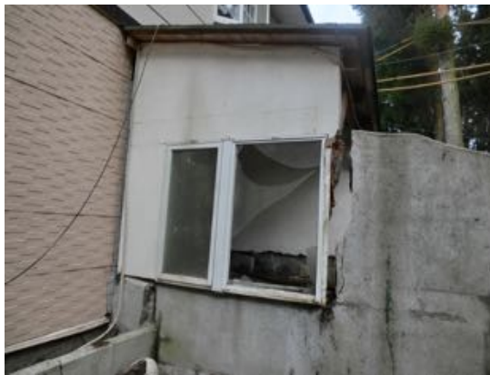
写真 5.1.10 宿泊棟北側の浴室の破壊
