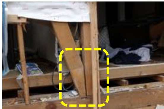
写真 4.4 写真 4.3 のアパートの柱頭部 (柱脚、筋かい端部は釘打ちのみ)
