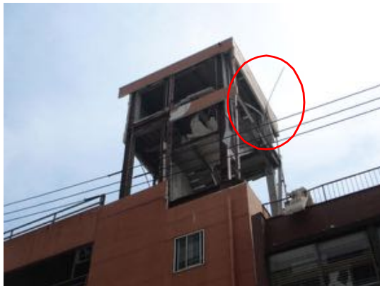
写真 4. 2. 1. 14 塔屋のブレースの破断
