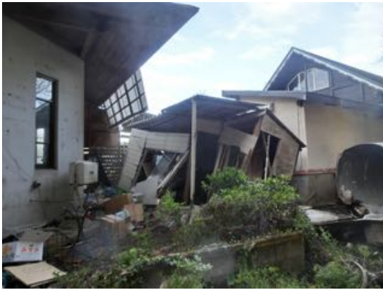
写真 5.1.13 食堂棟東側の付属屋の大破
