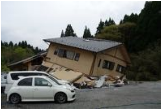
写真 4.11 倒壊した木造住宅
