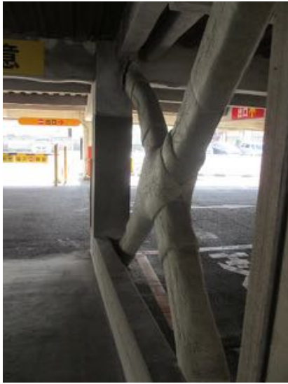
写真 4. 2. 1. 3 ブレースの座屈
