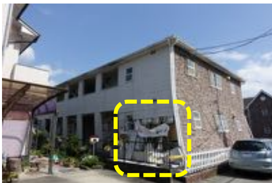
写真 2.23 大きく傾斜した木造アパート
