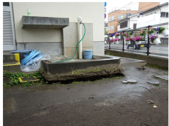
写真 5.12 小学校校舎の周辺地盤の沈下状況（熊本市南区近見）
