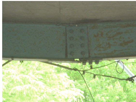
写真 5.2.3 梁下フランジ添え板の孔欠損部破断
