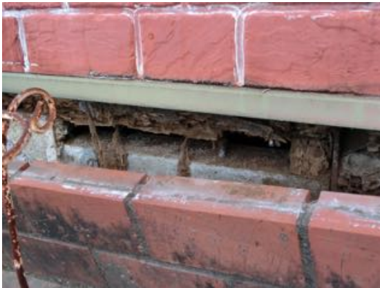
写真 5.2.11 写真 5.2.10 の建築物の躯体の 腐朽
