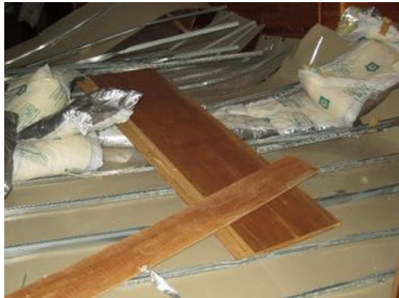
写真4.2.2.8 脱落した天井材
