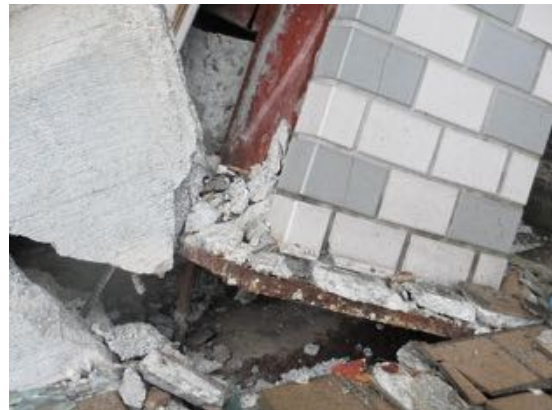
写真 4. 2. 1. 17 柱脚部の損傷状況
