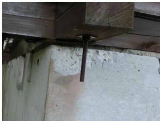
写真 5.1.20 ログハウスのコンクリート基礎の軽微な損傷
