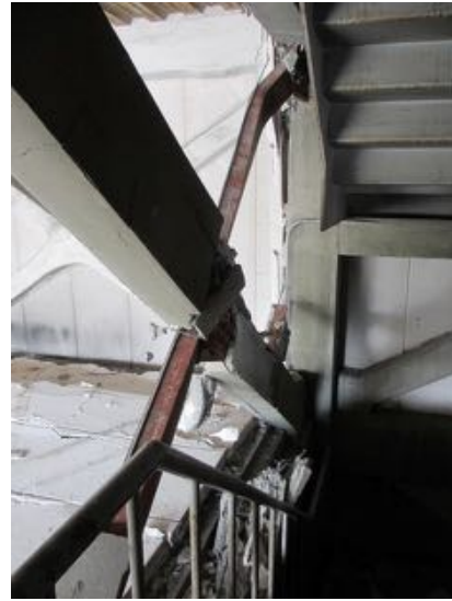
写真 4. 2. 1. 4 ブレースの耐火被覆の剥落
