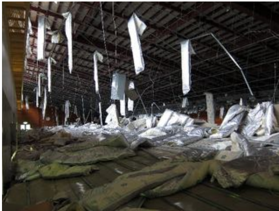
写真4.2.2.7 天井脱落の状況
