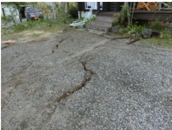
写真 5.1.15 ログハウスの南側地盤の亀裂
