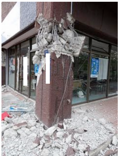
写真 3.1.19-3 1 階柱の大破(南東側)
