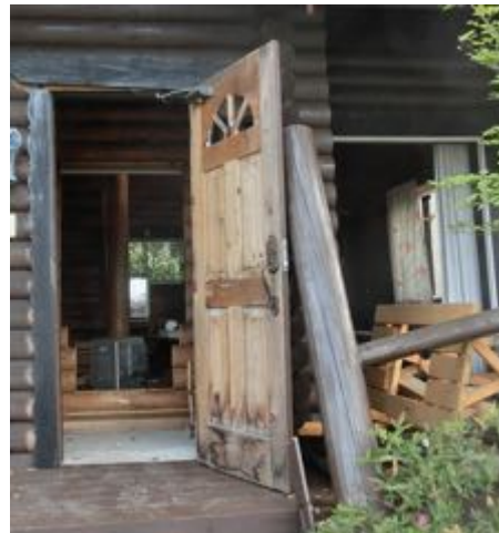
写真 5.1.16 ログハウス入り口付近の 独立柱の脱落
