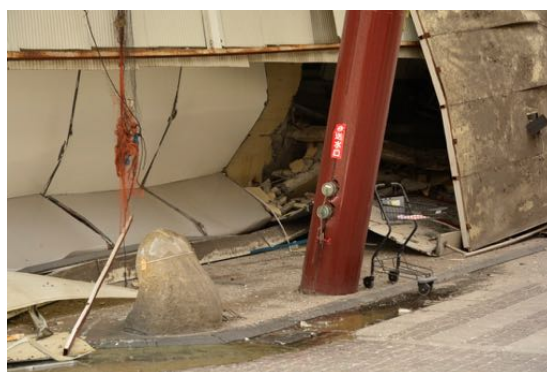
写真 4. 2. 3. 3 連結送水管送水口の付近の破損
