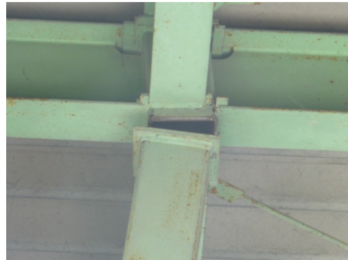
写真 5.14.4 パネルとダイアフラム間の溶接部の破断
