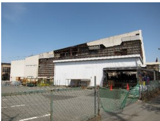
写真4.2.2.15 湿式工法による壁の脱落
