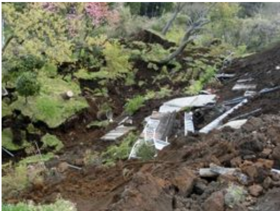
写真 5.2.9 写真 5.2.6 の眼下の地盤崩壊
