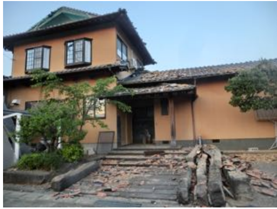
写真 5.5.9 土葺きの屋根瓦のみの被害
