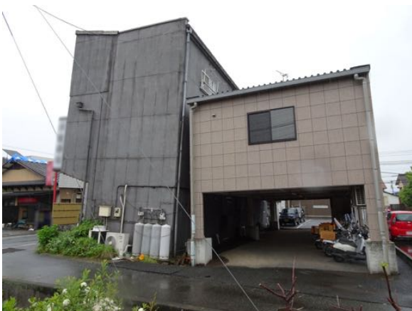
写真 5.16 地盤の液状化によると思われる隣接建築物同士が近づくような傾斜形態
