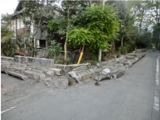
写真 5.5.14 組積造の塀の被害
