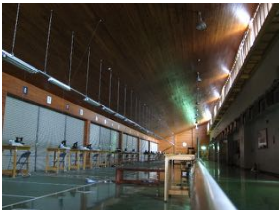
写真4.2.2.10 天井が脱落しなかった室
