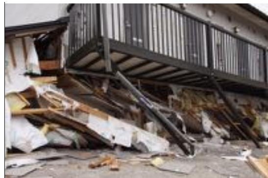
写真 4.18 1層部分の破壊状況
