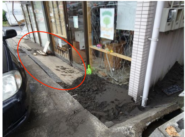
写真 5.6 写真 5.5 の建築物の 1 階部分の沈下状況
