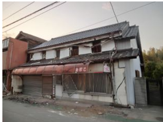
写真 5.5.7 土壁を有する伝統的な町屋の被害
