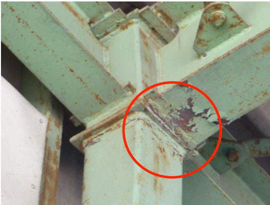
写真 5.14.3 梁端溶接部の破断
