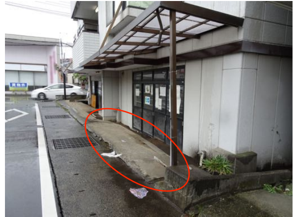
写真 5.15 写真 5.14 の建築物の 1 階部分の沈下状況
