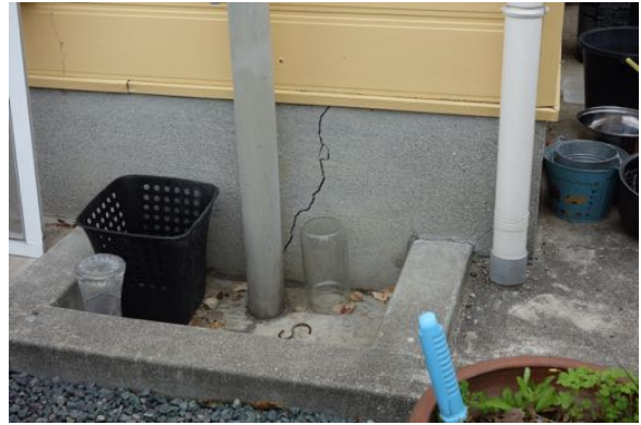
写真 4.8 写真 4.6 の建築物の基礎の様子。ひび割れを確認
