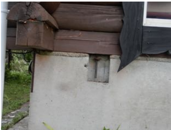
写真 5.1.19 ログハウス丸太の締め付けボルトの緩み
