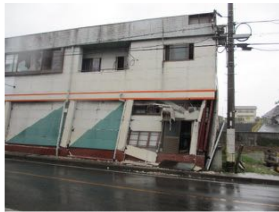
写真4.2.1.25 1層の大きな傾き（南面）
