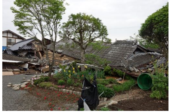
写真 4.13 倒壊した建築物。県道 28 号南側は古く見える建築物が多数倒壊
