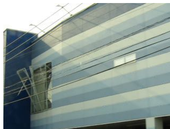
写真4.2.2.18 窓サッシの損傷・外れ
