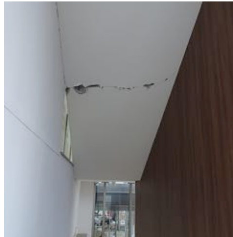
写真 3.1.16-2 階段底面に見られたひび割れ
