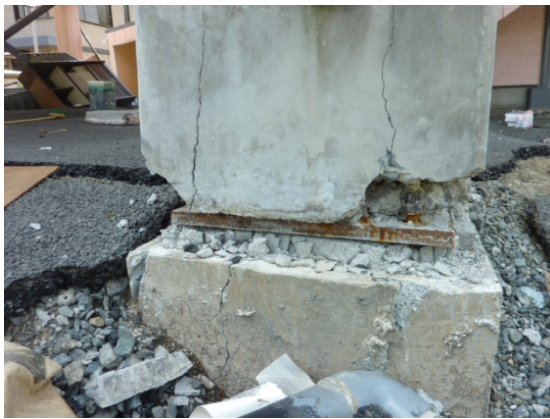
写真 5.15.3 柱脚部の損傷状況
