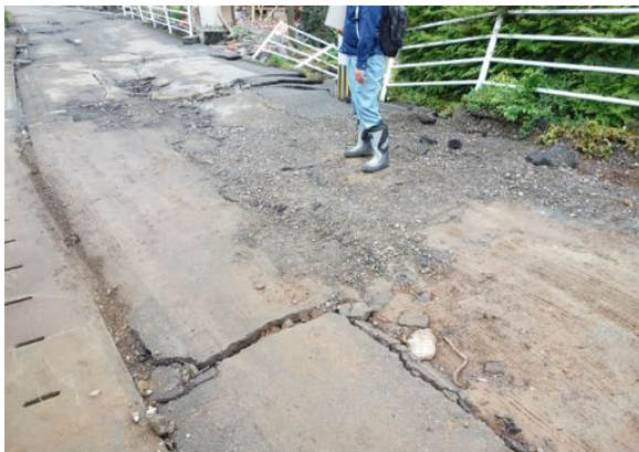
写真 4.28 B 通り・県道 28 号南側の道路の舗装の様子。砂利による応急措置が取られていると思われる。
