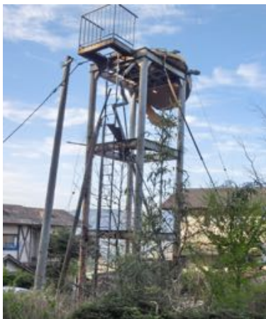
写真 5.2.5 給水タンクの落下
