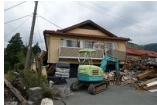
写真 4.12 倒壊した木造住宅
