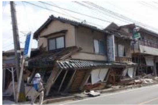
写真 2.6 大きく傾斜した店舗併用住宅
