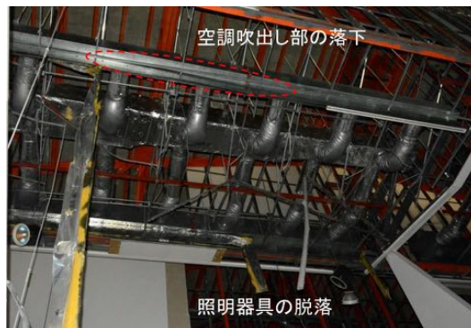
写真 4. 2. 3. 5 照明器具・空調吹き出し部の脱落
