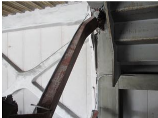
写真 4. 2. 1. 6 溝形鋼ブレース端部の座屈
