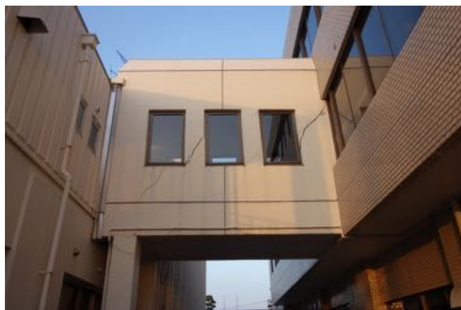
写真 5.4.5 渡り廊下の損傷
