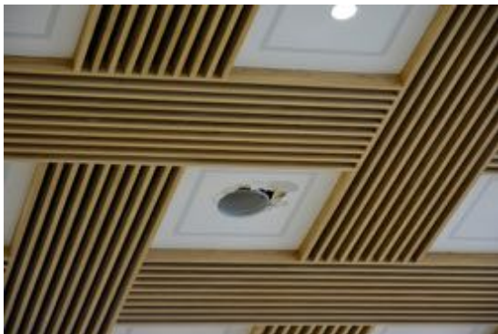
写真 4.2.3.6 空調吹出し部の脱落
