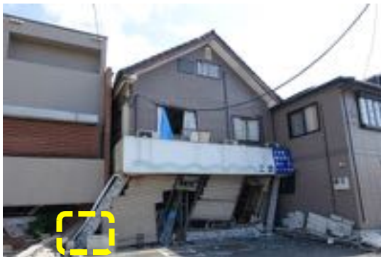
写真 2.9 大きく傾斜したS造店舗併用住宅 (隣のRC造の倒壊の影響の可能性あり)
