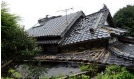
写真 3.3 倒壊した木造住宅
