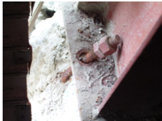
写真 5.8.2 柱脚部の損傷状況
