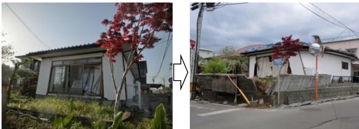
写真 6.2.1 建具が外れただけの住宅(左：4/15)が大きな傾斜になった(右：4/16)例
