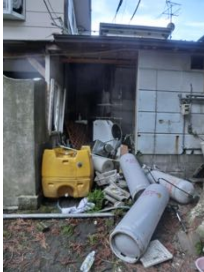
写真 5.1.12 宿泊棟接続部北側の被害状況
