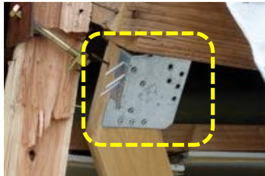
写真 4.17 写真 4.16 の住宅の柱頭部 （壁倍率 2 倍用筋かい金物）
