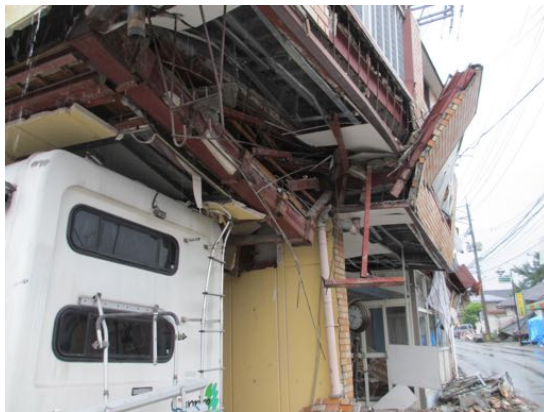
写真 4.2.1.20 崩壊した2層部分
