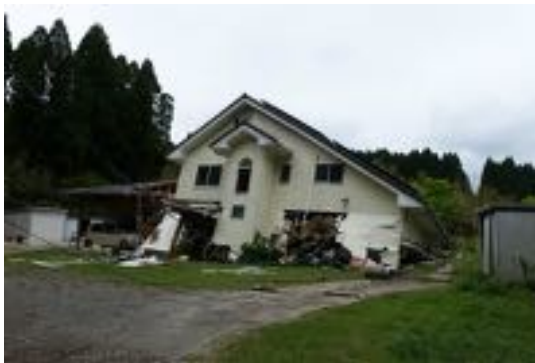
写真 4.15 倒壊した木造住宅（金物あり）
