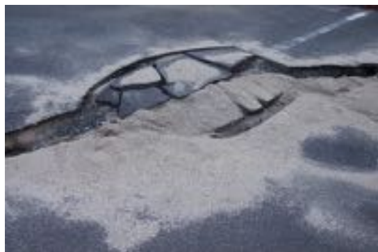
写真 2.32 液状化と推測される痕跡
