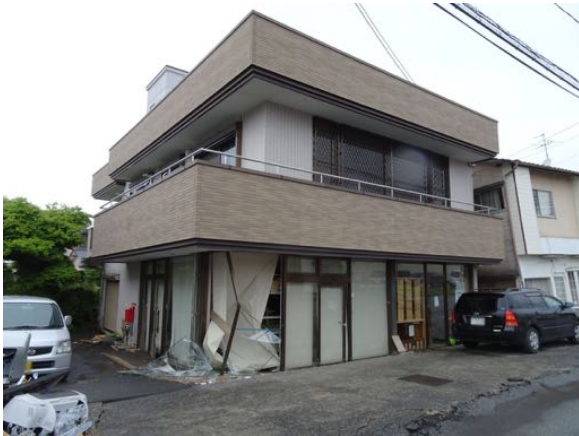
写真 5.5 地盤の液状化により沈下・傾斜したと思われる 2 階建て店舗併用住宅
