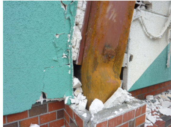
写真 5.6.2 柱の局部座屈
