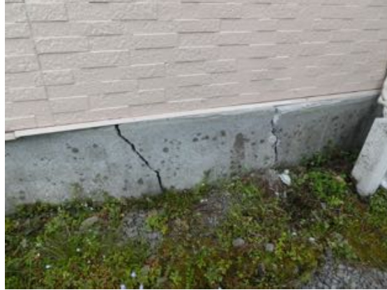
写真 5.1.6 宿泊棟の基礎の亀裂
