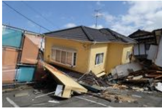
写真 2.14 倒壊した木造住宅
