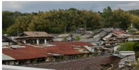
写真 5.6.2 屋根の被害が多い益城町小谷
