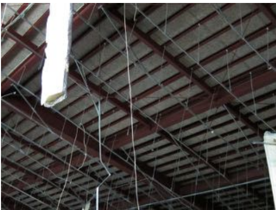
写真4.2.2.9 天井が脱落した天井懐の状況
