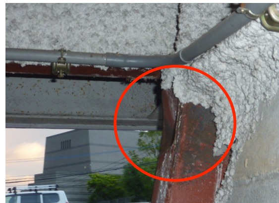
写真 5.12.4 柱の局部座屈
