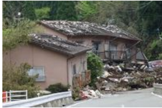
写真 4.10 倒壊した木造アパート
