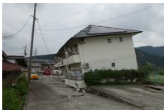
写真 4.6 横ずれした木造アパート
