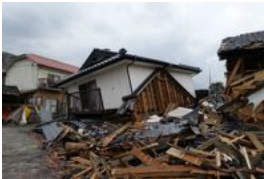
写真 4.13 倒壊した木造住宅
