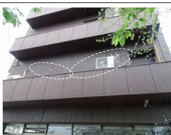
写真 3.1.19-2 耐力壁のせん断ひび割れ(東側)
