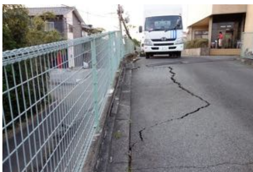
写真 5.4.4 敷地内の舗装のひび割れ
