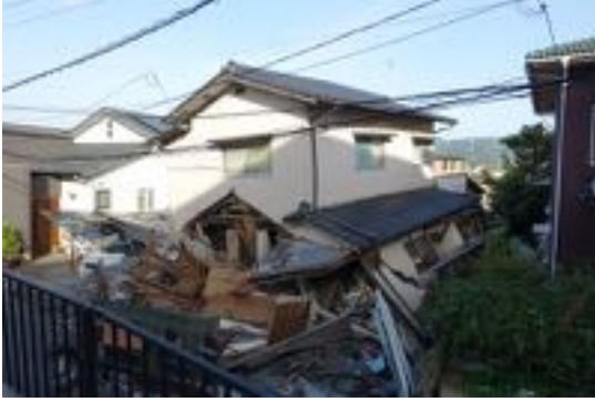
写真 2.29 倒壊した木造住宅
