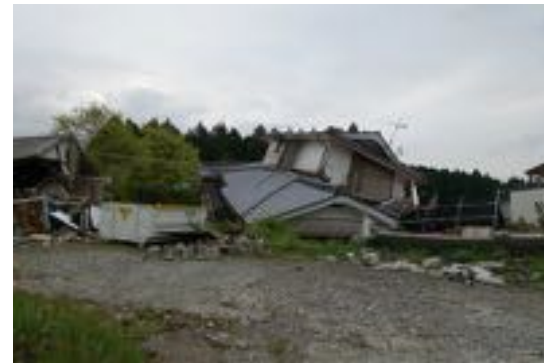
写真 4.14 倒壊した木造住宅
