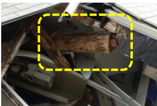
写真 4.27 柱脚部の生物劣化
