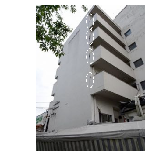
写真 3.1.20-2 外観 (北東側) バルコニー端部のひび割れ
