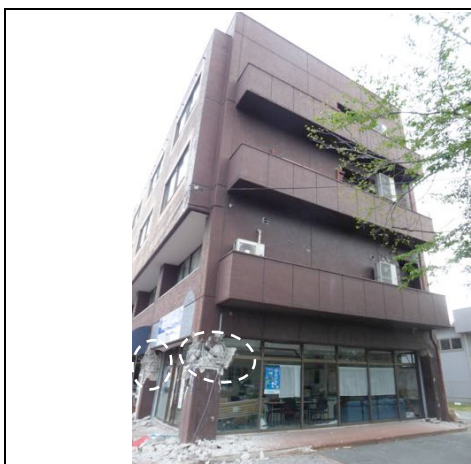
写真 3.1.19-1 外観(南東側)と大破した 2 本の柱
