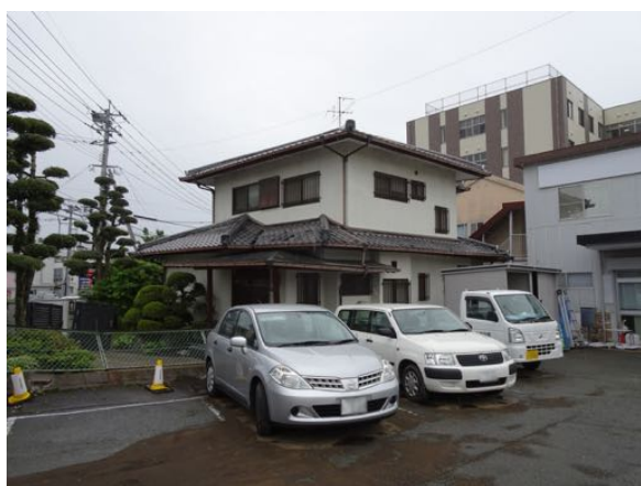
写真 5.1 地盤の液状化により沈下・傾斜したと思われる 2 階建て木造住宅
