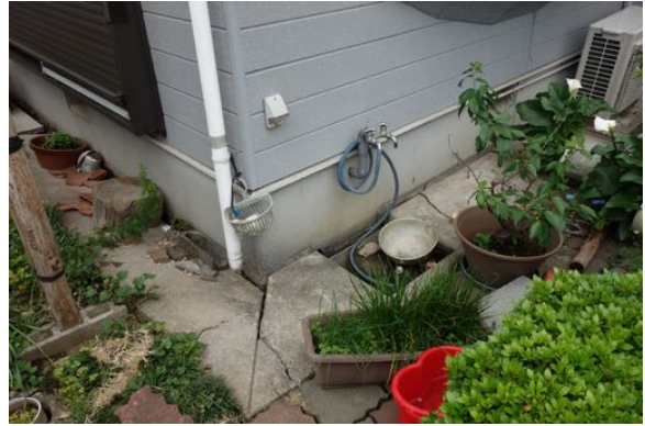
写真 4.15 写真 4.14 の基礎周りの様子。地盤変状が生じていると思われる損傷が見られる。
