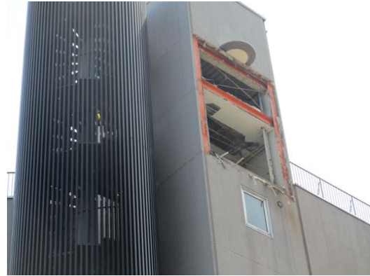
写真 4.2.1.9 塔屋の外装材の脱落
