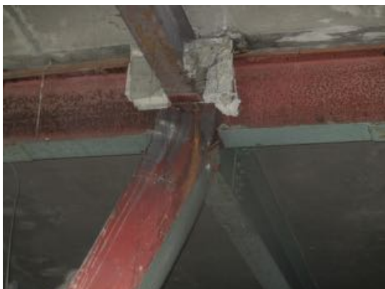
写真4.2.1.31 1階柱頭部の破壊
