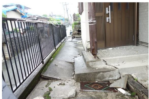
写真 4.24 写真 4.23 の建築物周辺地盤の様子。盛土擁壁に変位した形跡あり。
