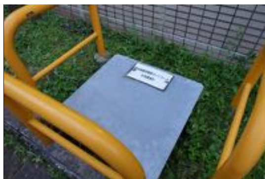
写真 3.2 震度計の設置状況
