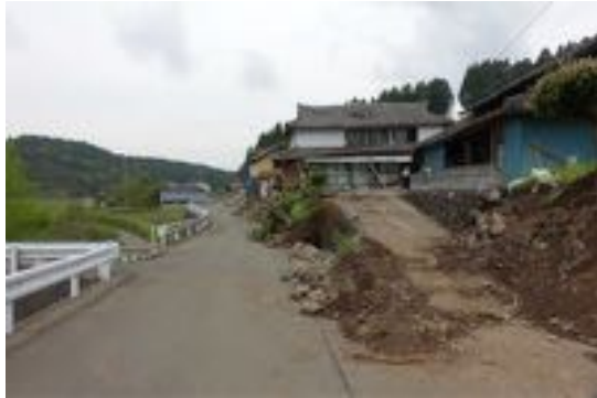
写真 3.20 崩壊した擁壁
