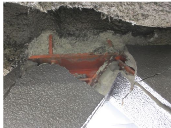
写真 4.2.1.11 ブレース交差部の耐火被覆の剥離
