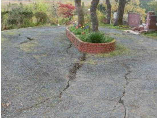
写真 5.2.7 駐車場の地割れ
