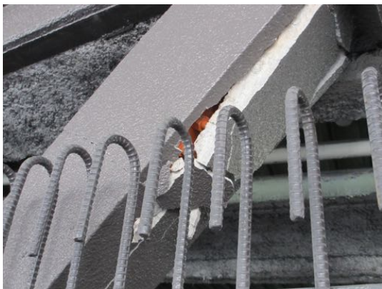
写真 4.2.1.10 ブレース端部の耐火被覆の亀裂
