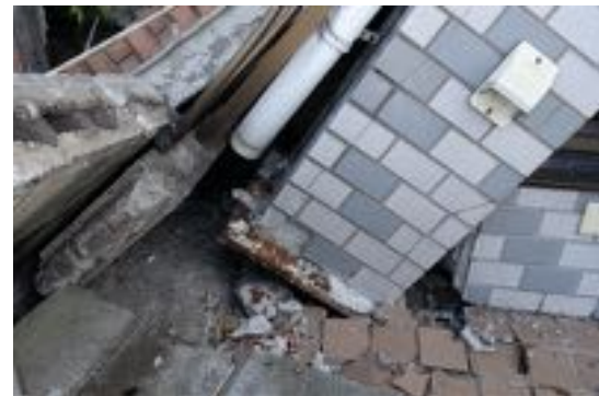
写真 2.10 写真 2.9 の建物の柱脚部
