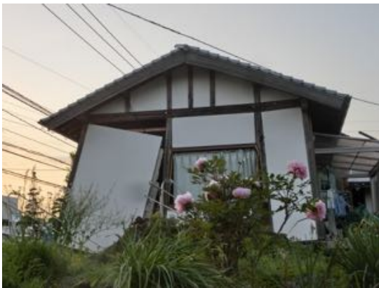
写真 5.5.4 壁が外れた家屋
