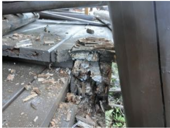
写真 5.1.18 写真 5.1.16 の独立柱脚部の腐朽
