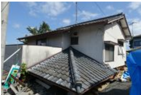
写真 2.19 倒壊した木造住宅
