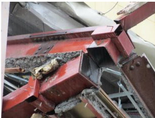
写真 4.2.1.22 柱梁接合部のパネル溶接部の破断
