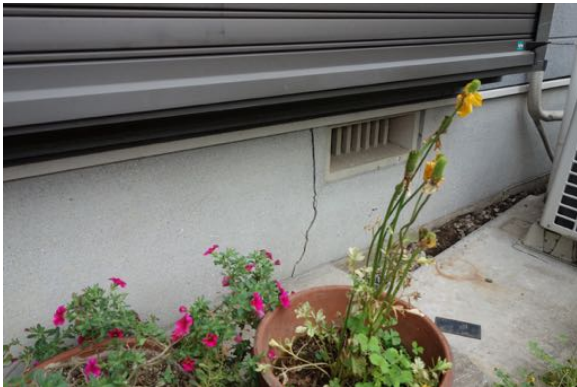
写真 4.16 写真 4.14 の建築物の基礎の様子。ひび割れを確認
