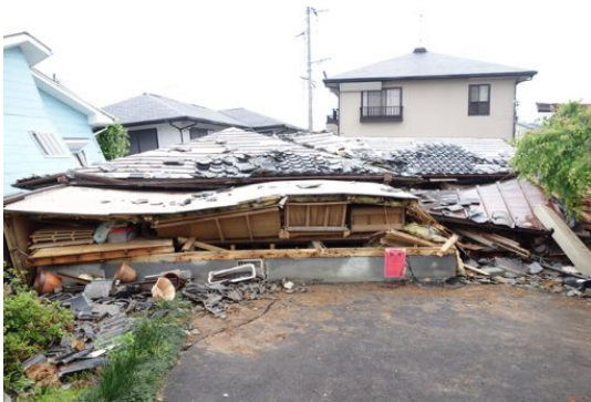
写真 4.40 被害の大きい建築物。周辺地盤の変状が認められ、基礎の損傷も認められる。
