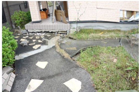
写真 4.39 写真 4.38 の建築物の周辺地盤。変状は認められるが、基礎の損傷は見えない。
