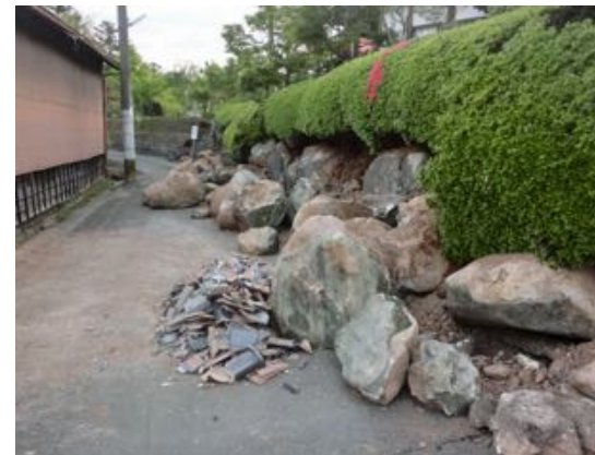
写真 5.5.13 石積み擁壁の被害
