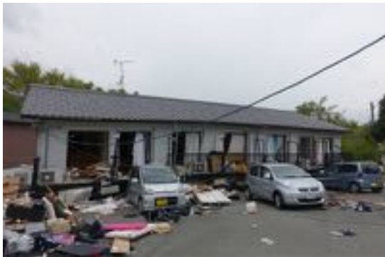
写真 4.17 倒壊したアパート①
