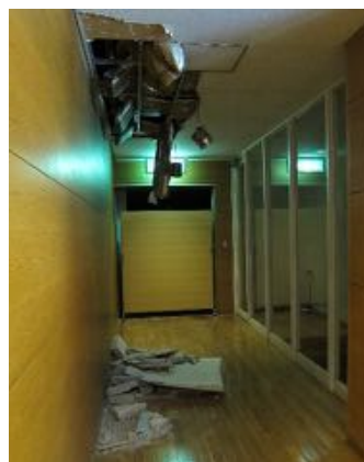
写真4.2.2.4 破損したコンクリート片の落下
