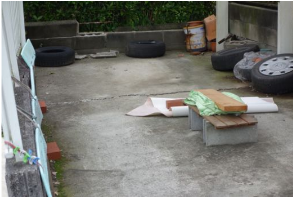
写真 4.7 写真 4.6 の建築物周辺の地盤変状
