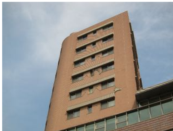
写真4.2.2.16 外壁タイルの脱落
