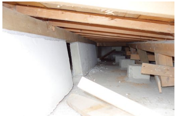
写真 4.33 写真 4.32 の建築物の基礎。床束は全て外れ、基礎は立ち上がり部で曲げ破壊が生じている。
