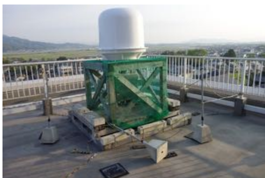
写真 5.4.3 屋上の設備の損傷（脚部）
