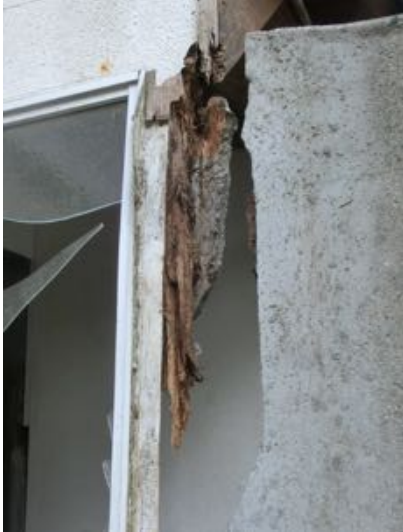
写真 5.1.11 写真 5.1.10 の木部の腐朽
