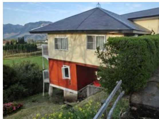
写真 5.2.16 1階の RC 支柱が傾斜した建築 物
