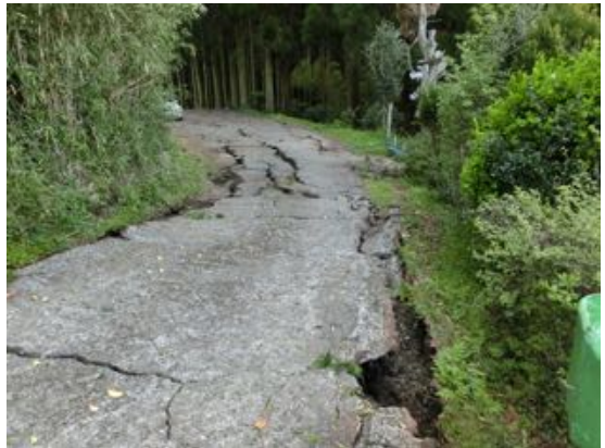
写真 5.2.4 エリア内の道路の亀裂
