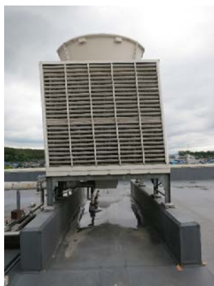
写真 4-26 基礎部分から傾斜した冷却塔
