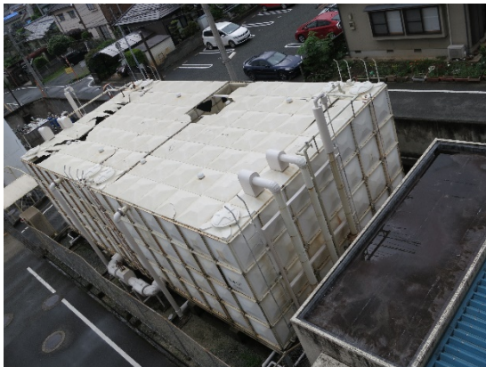
写真 4-21 受水槽天板の被害
