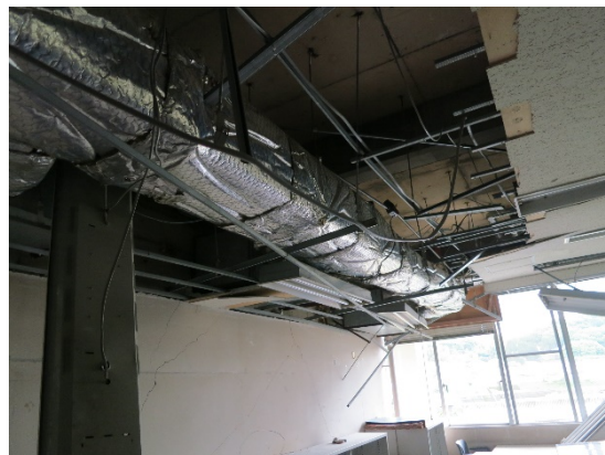
写真 4-29 空調ダクトの被害
