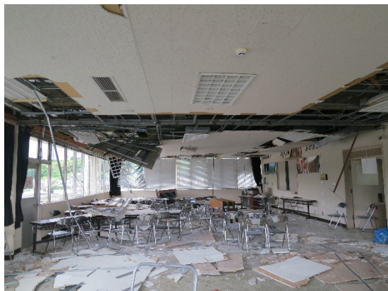
写真 4-28 天井材の被害
