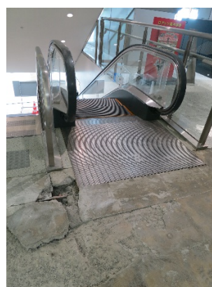
写真 4-6 エスカレーター接続部の被害
