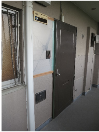
写真 4-7 開閉障害が発生した玄関扉
