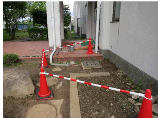
写真 4-32 地下埋設給水配管の破損箇所付近
