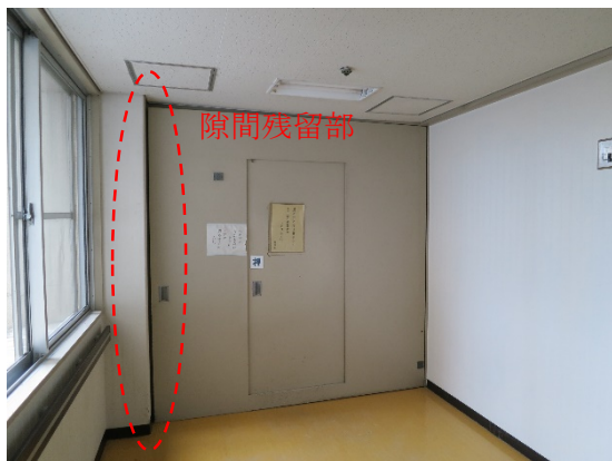
写真 4-23 完全には閉鎖しなくなった防火戸
