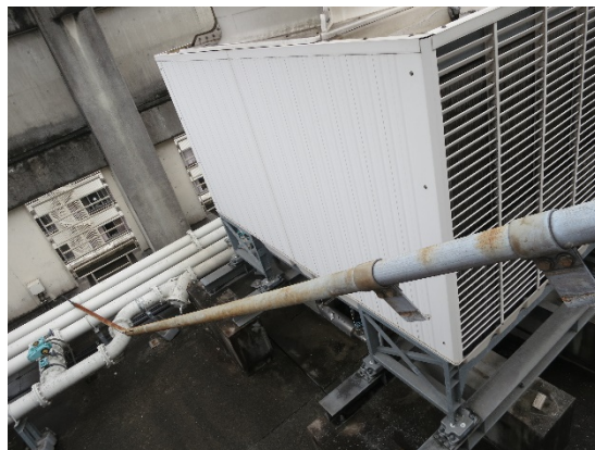
写真 4-25 支持部の破損により転倒した避雷針
