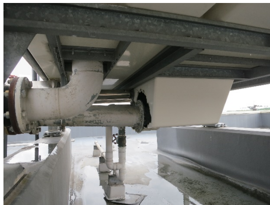
写真 4-27 冷却塔と冷却水配管接続部の被害
