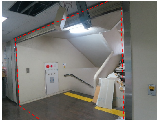
写真 4-30 自動閉鎖したのち開放できなくなっていた防火シャッター
