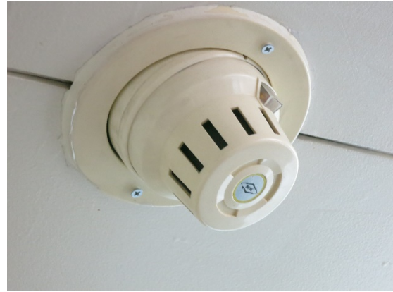
写真 4-15 煙感知器の歪み
