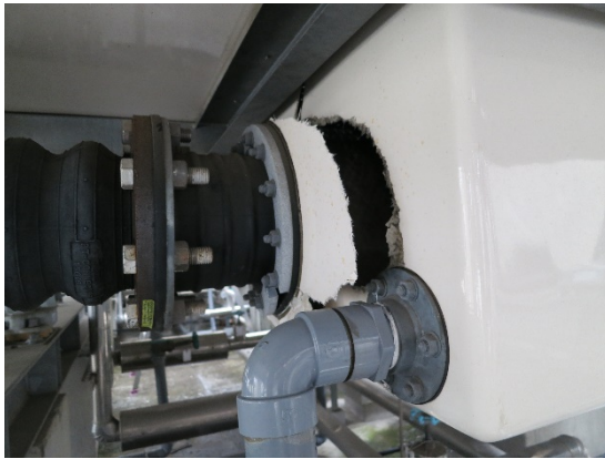
写真 4-18 冷却塔配管と冷却水配管接合部の被害
