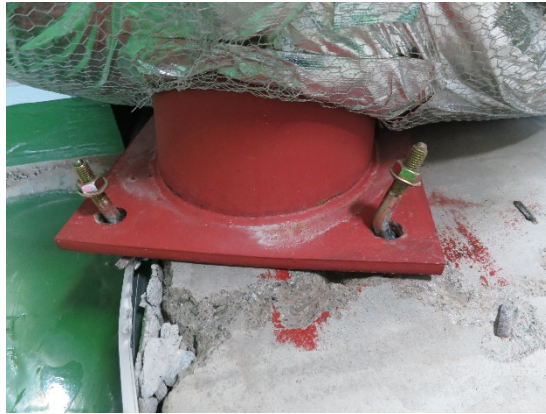
写真 4-9 温水器用貯湯タンクのアンカー接合部分の被害
