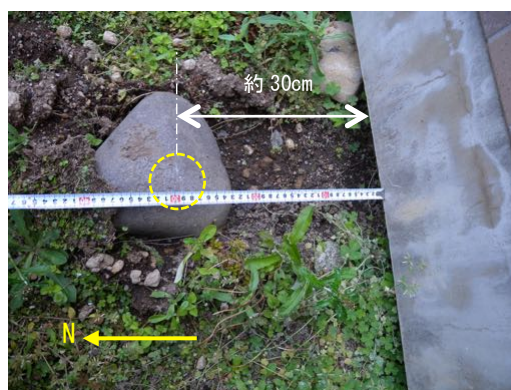
写真 5.7.2 免震層周囲の石の移動跡
