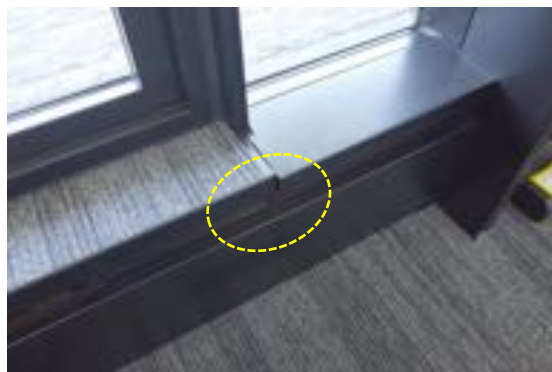
写真 5.2.4 窓サッシ部の金具のずれ
