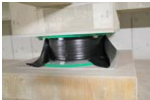
写真 5.3.2 積層ゴム被覆カバーの外れ
