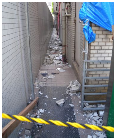
写真 5.2.6 隣接建物（右）の外装材落下被害
