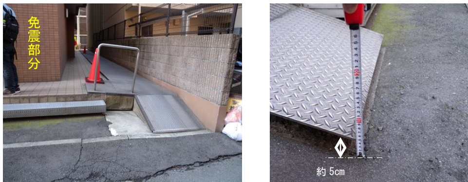
写真 5.9.6 周囲における地盤沈下の痕跡 (隣接する塀の傾斜、エキスパンション部の隙間)
