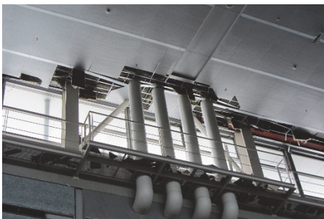
(e) 天井端部の損傷 (b ホール)
