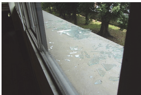
(c) 剣道場ガラス破損
