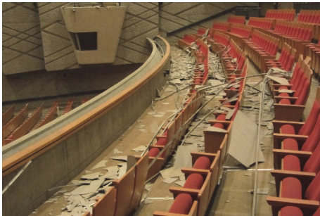
(k) 2階客席への天井の脱落
