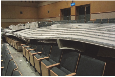
(d) 脱落した天井面
