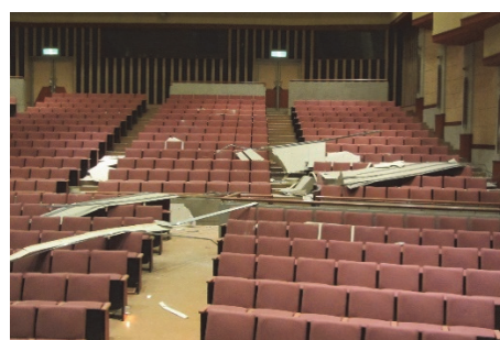
(f) 脱落した天井
