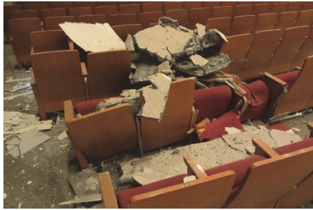
(c) 1階客席へのラスモルタル天井の脱落
