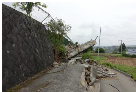
写真 11 崩壊した擁壁
