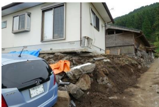
写真 10 崩壊した擁壁
