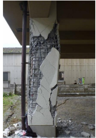
写真3 付着割裂破壊した柱
