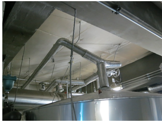
写真 4-11 ボイラー貯湯槽の配管の被害
