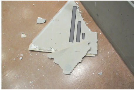
(i) 落下した三角形のせっこうボード（天井取合い内壁と思われる。）
