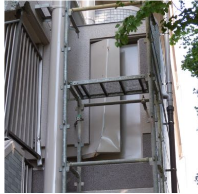
写真 5.8.6 同 変状③（カバーの変形）
