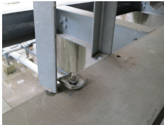
写真 4-20 冷却塔支持材の被害
