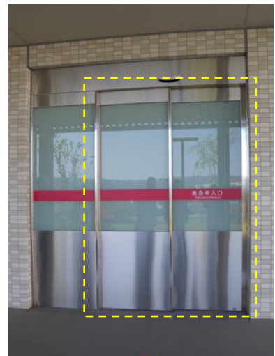
写真 5.1.5 外れた自動ドアの扉
