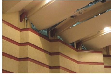
(h) 天井と内壁の損傷・落下
