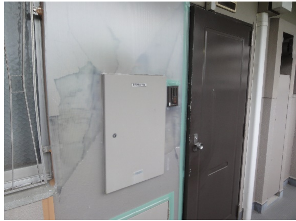
写真 4-8 方立て壁のせん断被害（等級IV）
