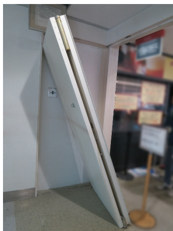
写真 4-3 ヒンジから脱落した防火戸
