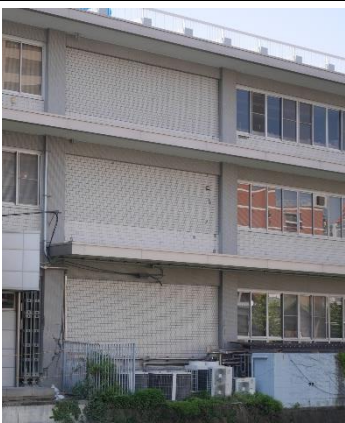
写真7 増設耐震壁側柱のせん断破壊
