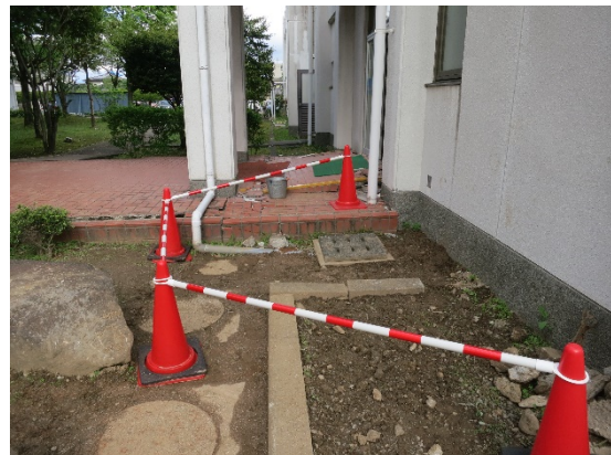
写真 4-32 地下埋設給水配管の破損箇所付近
