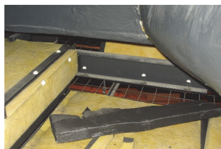
(d) 天井裏（H形鋼から短いボルトで吊り）
