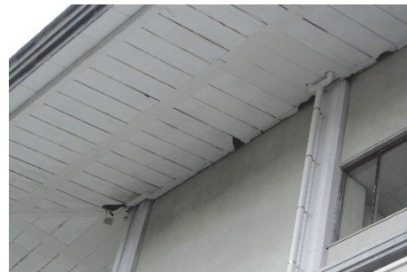
(j) 軒天の損傷
