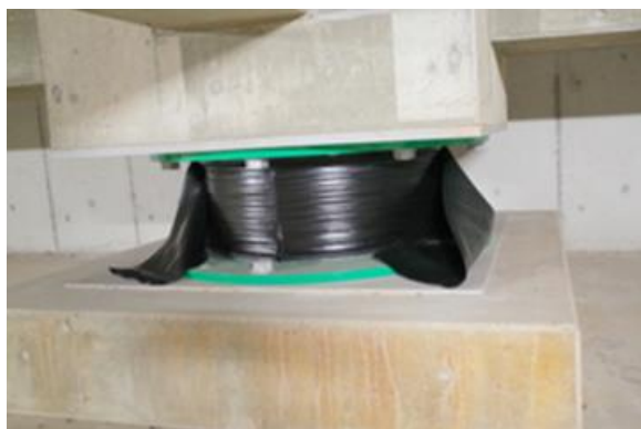
写真3 積層ゴムカバーの脱落
