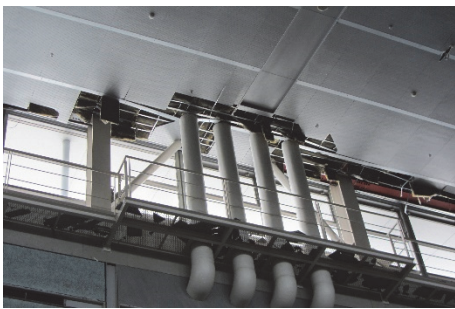
(e) 天井端部の損傷 (b ホール)
