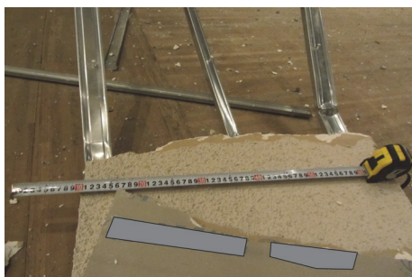
(g) 舞台上に落下した天井
