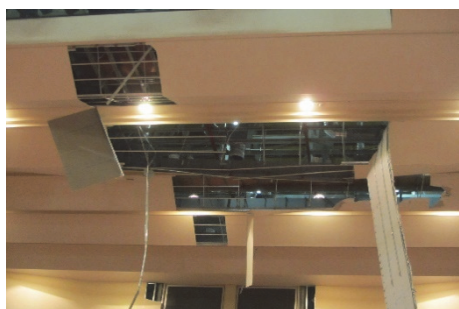
(c) 天井脱落部分
