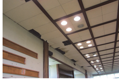
(f) 壁際や照明まわりの天井の一部脱落
