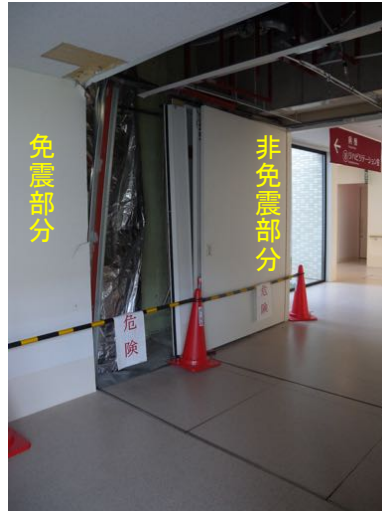
写真 5.1.4 破損したエキスパンションカバー（撤去済み）
