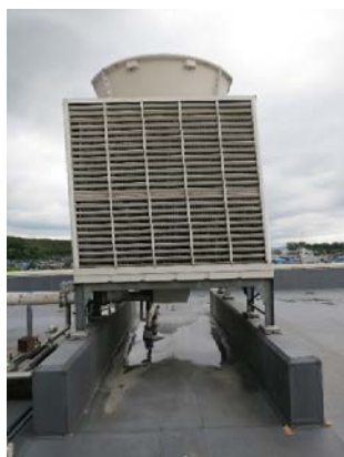
写真 4-26 基礎部分から傾斜した冷却塔
