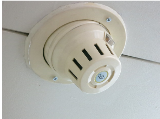
写真 4-15 煙感知器の歪み
