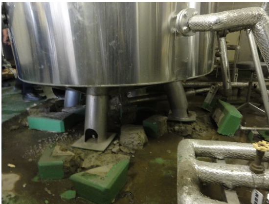
写真 4-10 ボイラー貯湯槽基礎の被害
