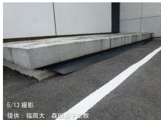
写真 5. 10. 2 免震スカートのはみ出し
