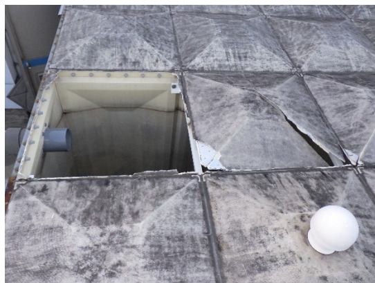
写真 4-2 屋外受水槽天板の被害
