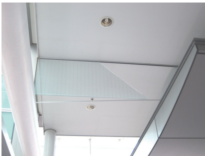
(m) ガラス防煙垂れ壁の被害 (通路棟)
