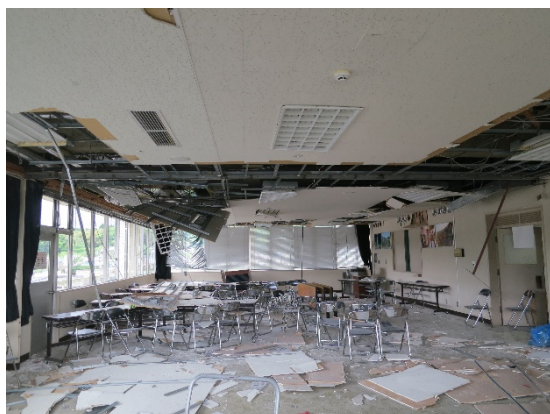
写真 4-28 天井材の被害
