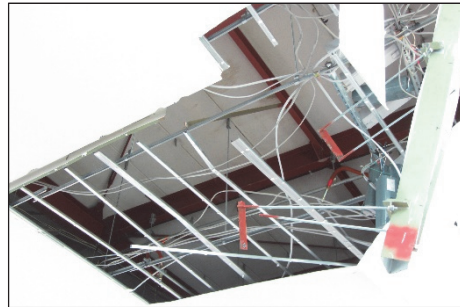
(l) 天井の一部落下 (通路棟。吊り元は ALC パネル)
