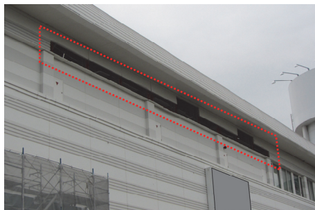
写真 10 商業施設における天井レベルでの ALC パネルの損傷
