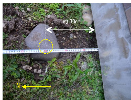
写真 5.7.2 免震層周囲の石の移動跡
