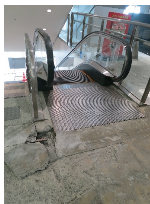
写真 4-6 エスカレーター接続部の被害
