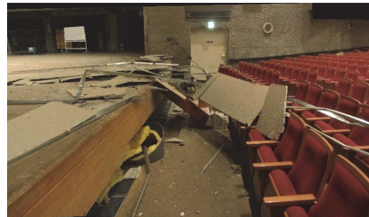
(f) 1階客席前方に落下した天井(せっこうボード(厚さ 12.5mm)+吹付)
