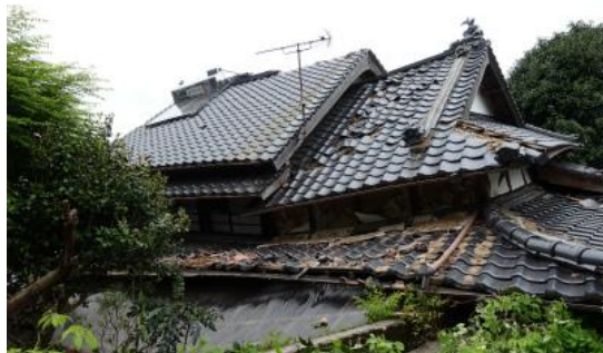
写真 8 倒壊した木造住宅
