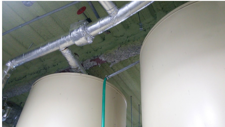
写真 4-17 耐火被覆が剥落した鉄骨梁
