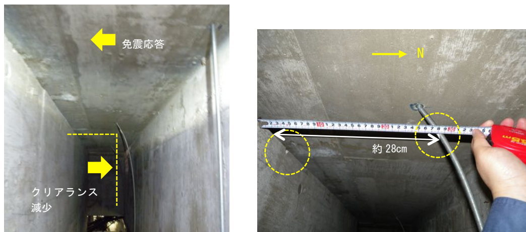
写真 5. 6. 1 配管吊り下げ用ボルトの変形（ボルトの接触痕から擁壁まで約 28cm）
