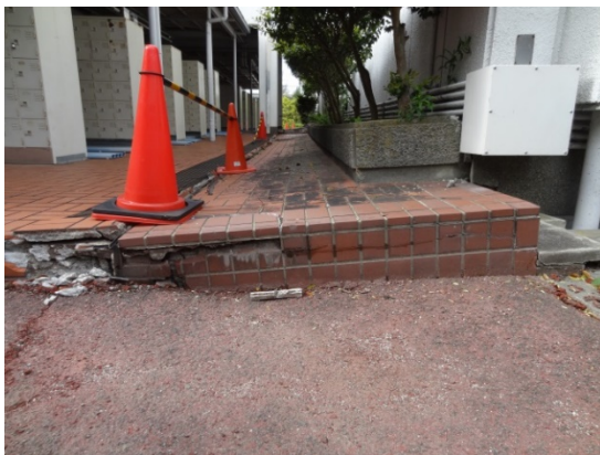
写真 4-31 建物と地盤面の段差
