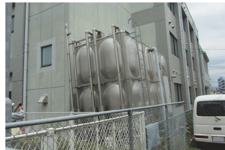
(g) 受水槽の傾き
