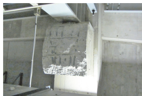
(f) S造屋根支承部の損傷（脱落）
