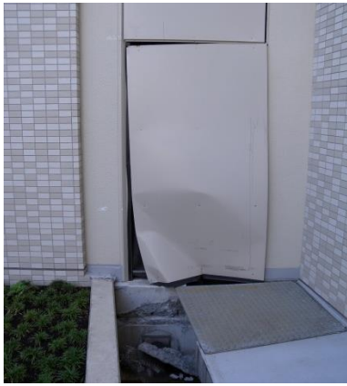
写真5 エキスパンションカバー 周囲の変状
