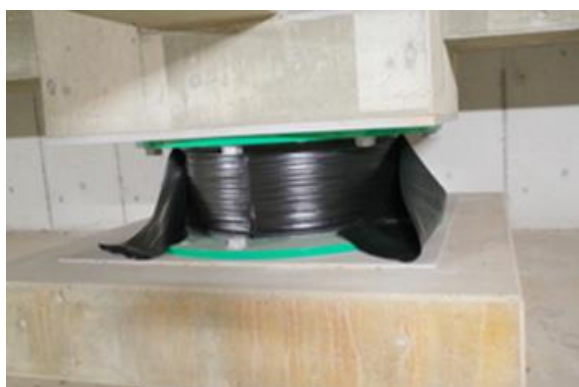
写真3 積層ゴムカバーの脱落
