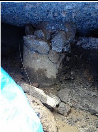
写真 3.5-7 コンクリート杭端部の損傷
