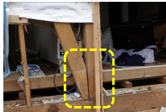
写真 3.3-15 写真 3.3-14 のアパートの柱脚部 (柱脚、筋かい端部は釘打ちのみ)
