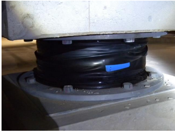
写真 3.7-6 化粧カバーのずれ及び胴部保護ゴムのめくれ (建築物A)
