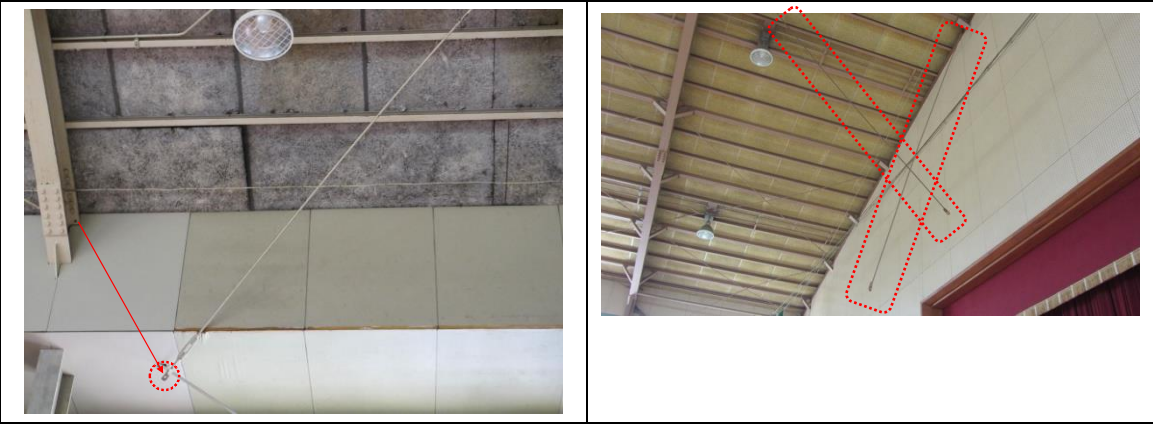
写真 3. 4-7 屋根面水平ブレースのボルト破断
