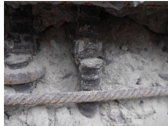
写真 3.5-2 溶接部が破断した柱主筋
