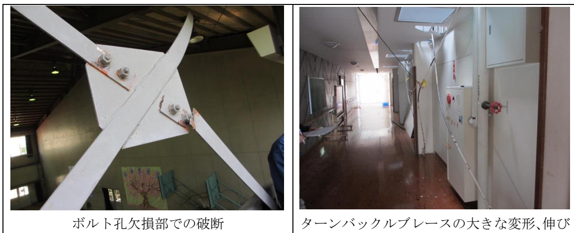
写真 3.4-4 鉛直ブレースの被害
