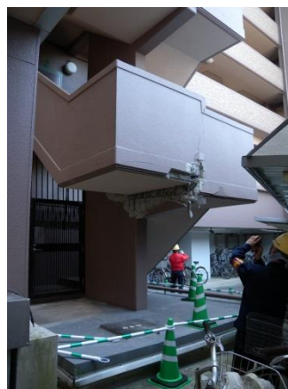
写真 3.7-4 外付け階段の被害 (建築物G)
