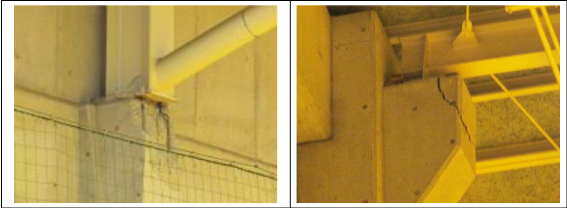
写真 3. 4-6 屋根支承部のコンクリート側方破壊の被害
