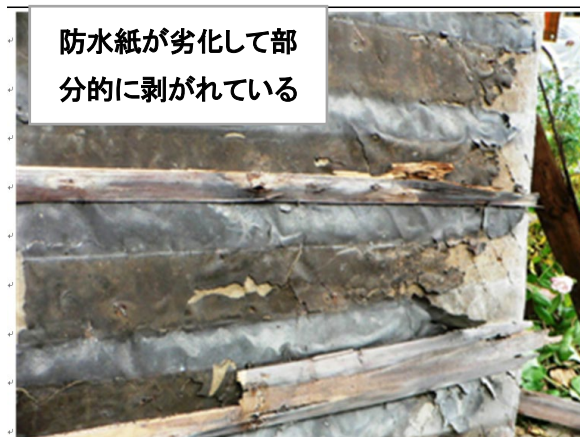
使用が禁止されている梱包用 8kg 品の劣化状況
