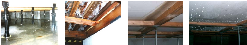
基礎打継からの浸水事例 床裏の木部湿潤事例 床裏断熱と木部の湿潤 床断熱材の結露と木部の湿潤
