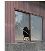
窓が割れた管理不全空家
