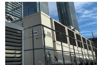
屋上の省エネ設備
