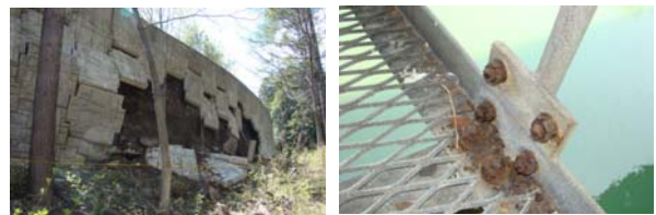
補強土擁壁の崩落
