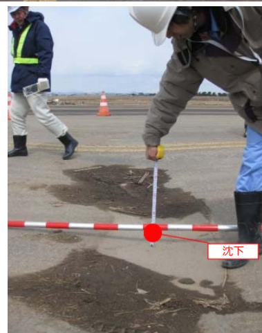
仙台空港の誘導路(アスファルト舗装)の液状化による局所沈下
