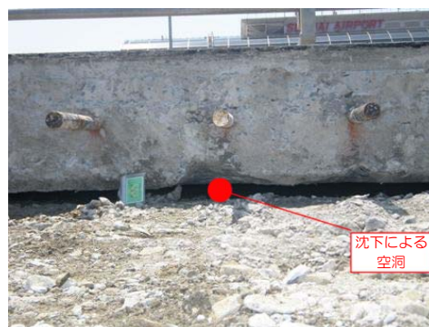
仙台空港のエプロン(コンクリート舗装)の液状化による局所沈下
