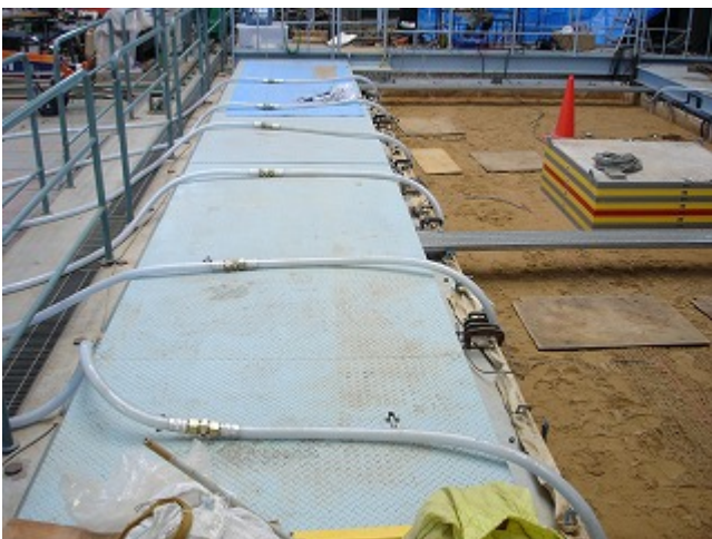
写真12 MB水注水縦配管
