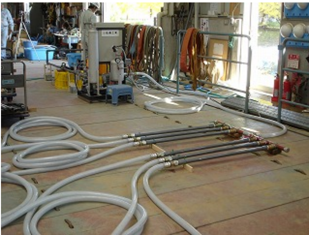
写真10 MB水注水分岐管
