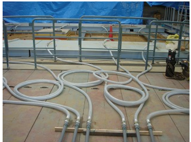
写真11 MB水注水配管
