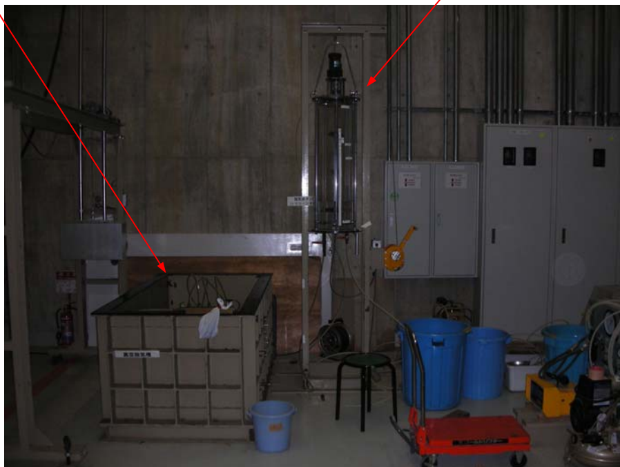
図 4.1-2 真空脱気槽とシリコンオイル圧入ポンプ
