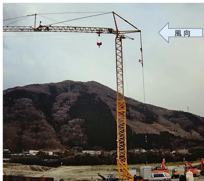
写真 2-4 クレーン未使用時のフック位置及び水平ジブの方向
