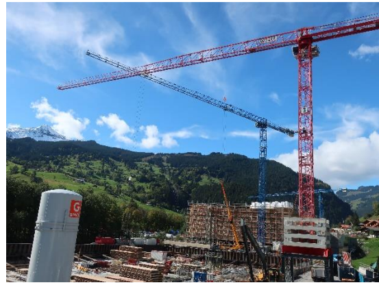
(b) 現場での設置状況
