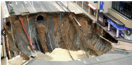
←福岡市地下鉄七隈線延伸工事現場での道路陥没
