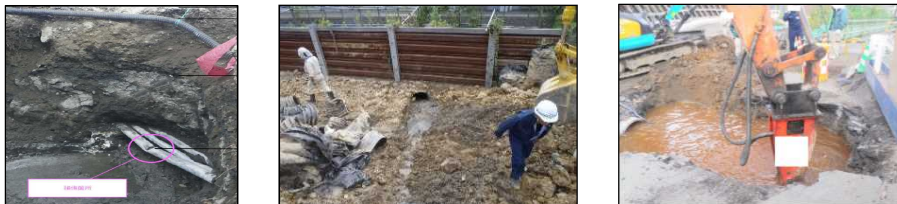
工事に伴う埋設物の損傷事故
