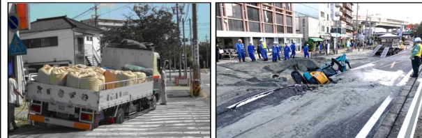
←上下水道等の老朽化に伴う道路陥没
