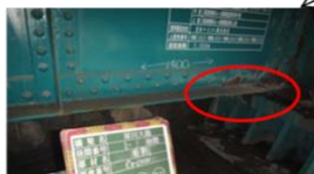
横桁に著しい板厚減少(健全部16mm、残存厚7mm)
