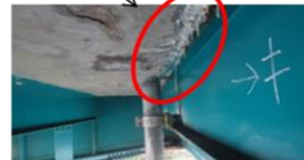
床版下面には漏水・遊離石灰や鉄筋露出が見られる
