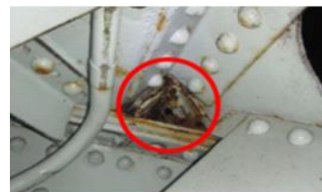
橋門工に断面欠損を伴う腐食
