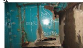
縦桁に断面欠損を伴う腐食
