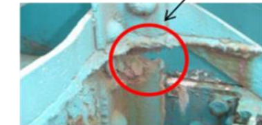
垂直材に著しい断面減少を伴う腐食や欠損⇒耐荷力を確認する必要あり
