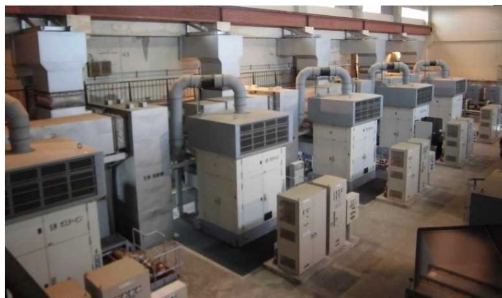
全景 (主原動機)
