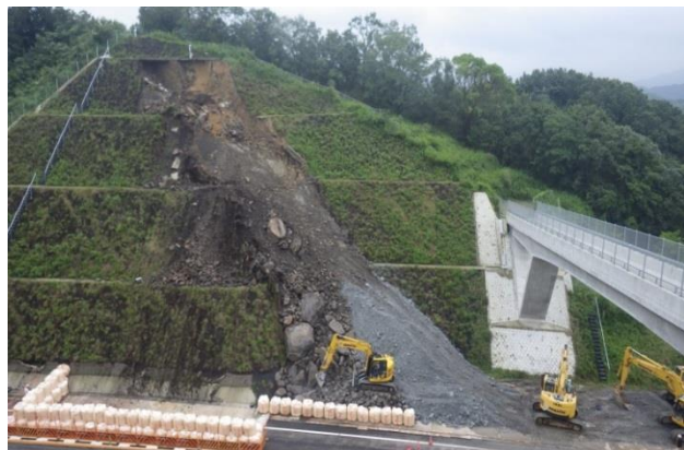
紀勢自動車道荒堀地区の崩壊事例
