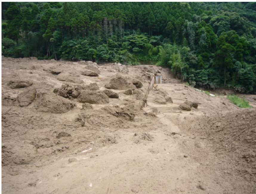
写真－4 1号砂防堰堤（平成22年7月7日午後撮影） 1号堰堤本堤付近にも多数の巨礫が堆積している。堆積土砂は非常にぬかるんだ状態となっている。
