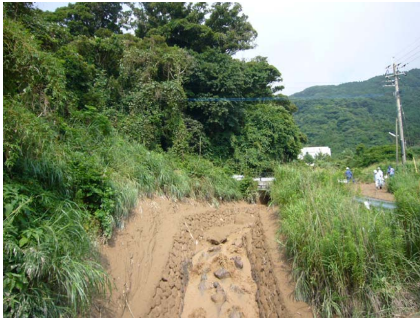
写真－8 国道 269 号より上流約 100mの橋から、上流側を望む （平成 22 年 7 月 7 日午後撮影） 下流流路工については、国道 269 号より上流約 100mの橋の部分までは、断面をオーバーした泥が側岸に付着しているものの、流路内の閉塞は見られなかった。
