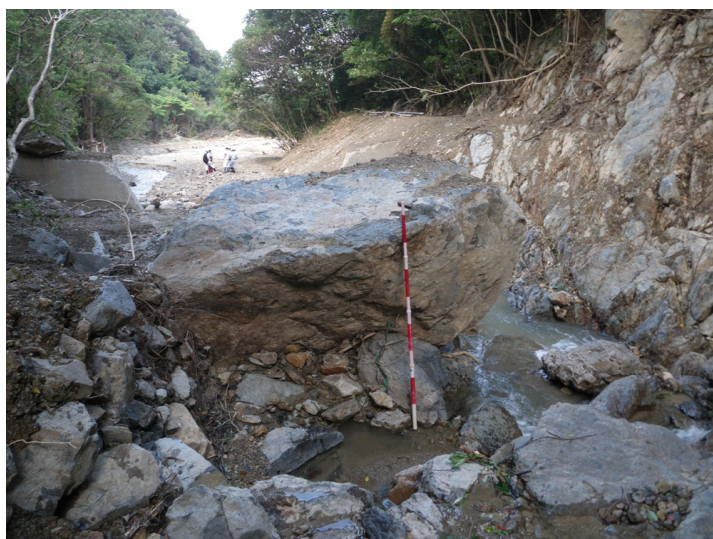
流出した巨礫（床固工上流）
