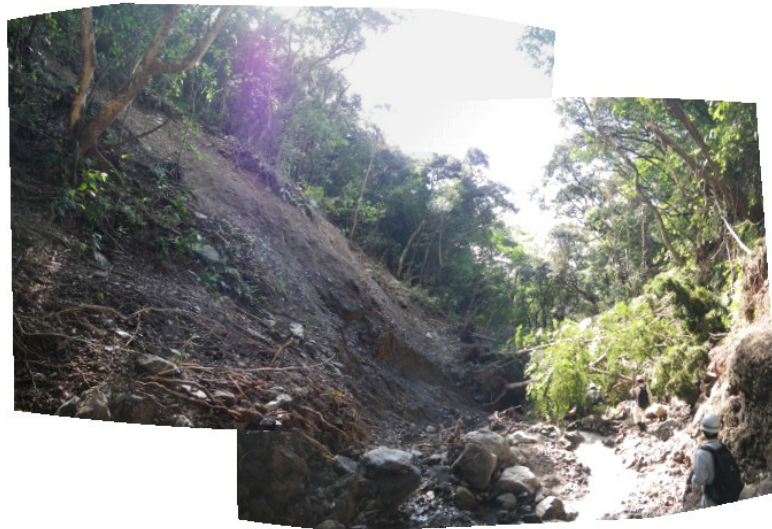
国道から 200m 程度上流左岸の小規模崩壊
