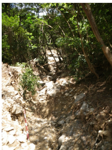
住用の園の対岸斜面の侵食状況
