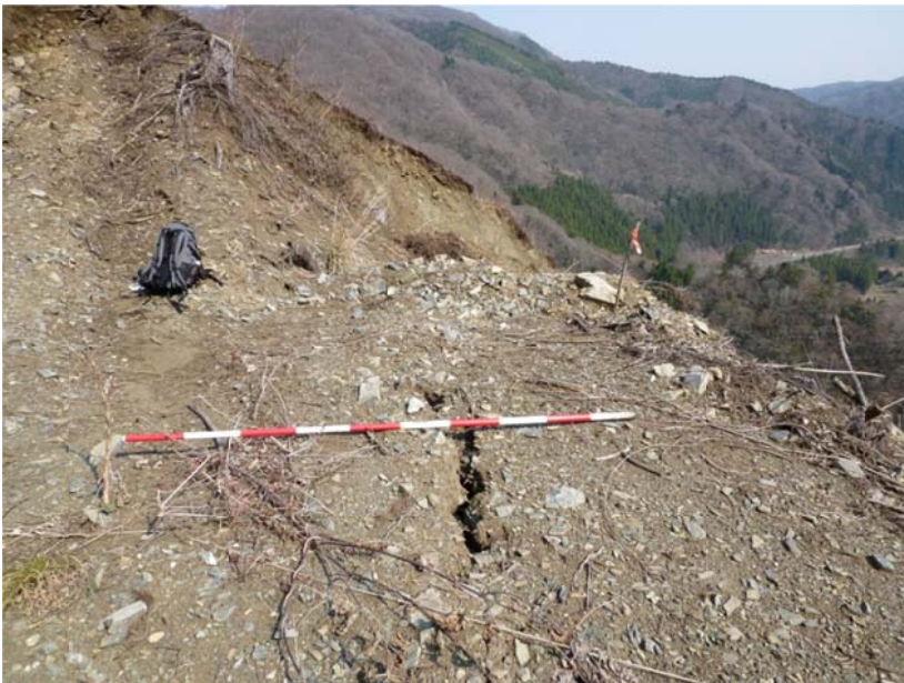
写真 10 斜面左側の作業道に見られたクラック
