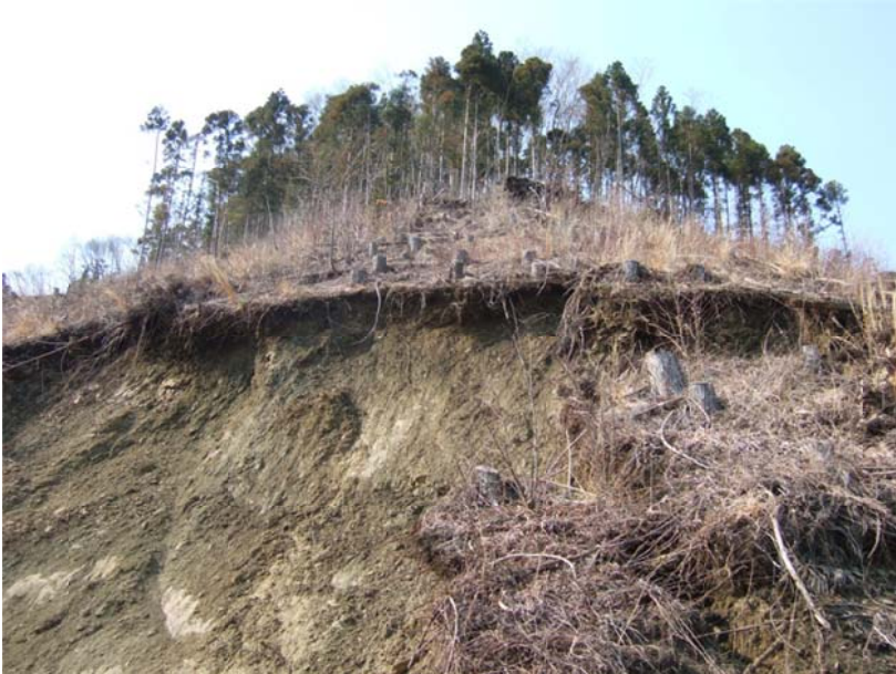
写真 9 最上部右側落ち残りのブロック
