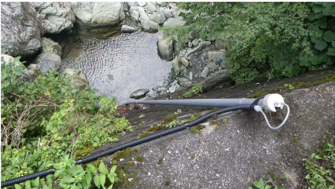
写真-10 水位計設置状況（東之谷川右岸側）
