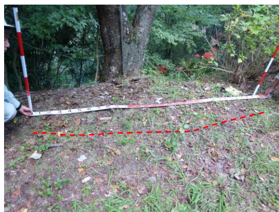
上の道の亀裂
