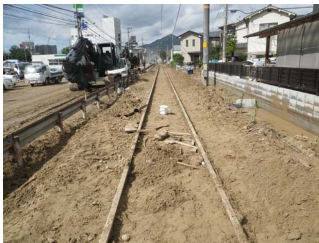
写真1 JR線路敷への土砂堆積状況
