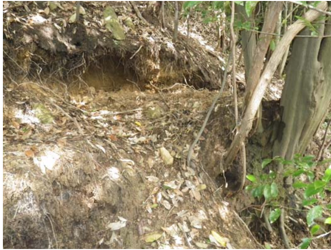
写真 1 0 溪流周辺の不安定土塊肩の状況
