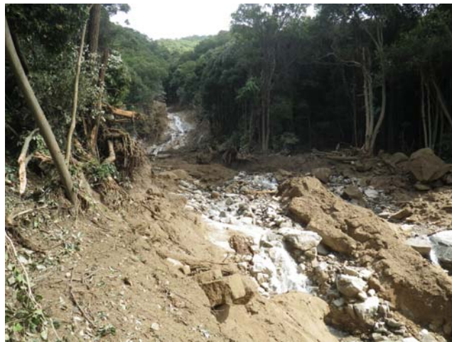
写真9 宅地上流部の表層土流出と溪流辺縁部の堆積状況
