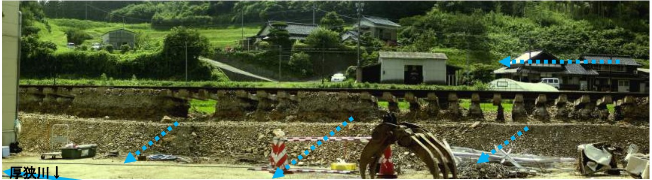
写真1 松ヶ瀬橋付近のJR 美祢線路盤流出箇所
