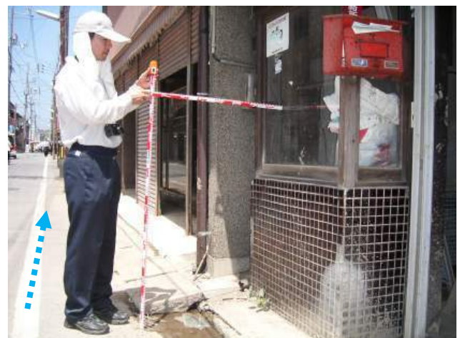
写真8 排水路東側商店街(浸水痕跡 約1.3m)
