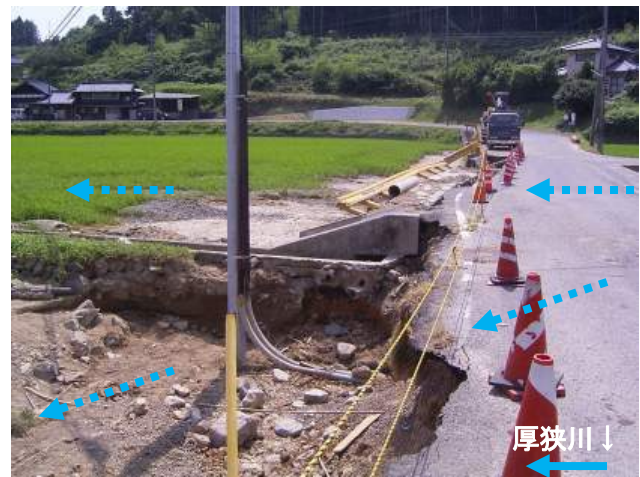
写真3 倒壊したガードレール
