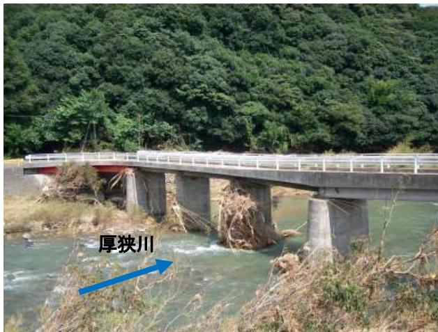
写真2 塵芥の引っ掛かった松ヶ瀬橋
