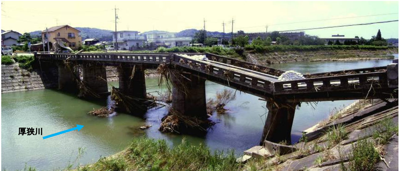
写真5 陥没した新橋
