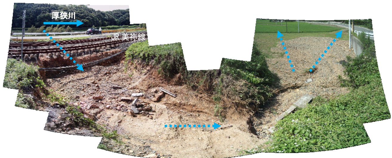
写真4 右岸列車交換施設直下流の路盤流出状況
