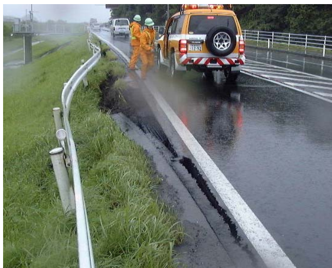
路肩陥没現場にパトロールカーが到着（'03 宮城県北部地震）
