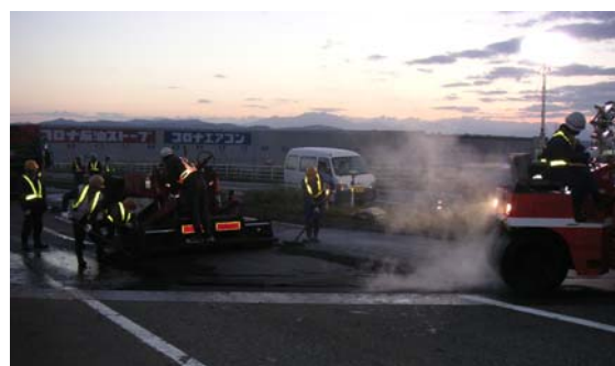
夜を徹しての応急復旧（’04 新潟県中越地震、長岡国道事務所）
