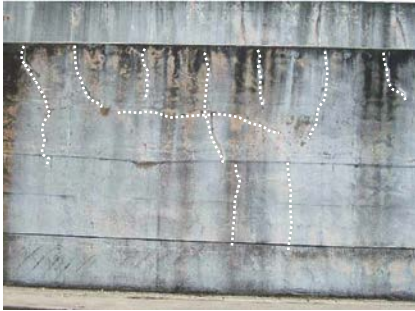
写真-3 平成20年の状況 (破線は、筆者が写真のひび割れをトレース)
