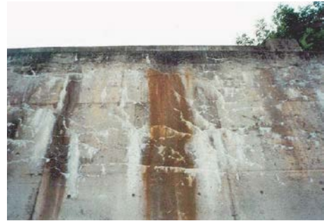
写真-2 平成10年補修前の状況
